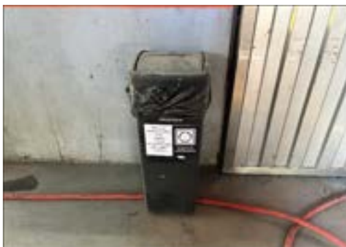
Figura 27. Recipiente de disposición de residuos en la zona de caldera
