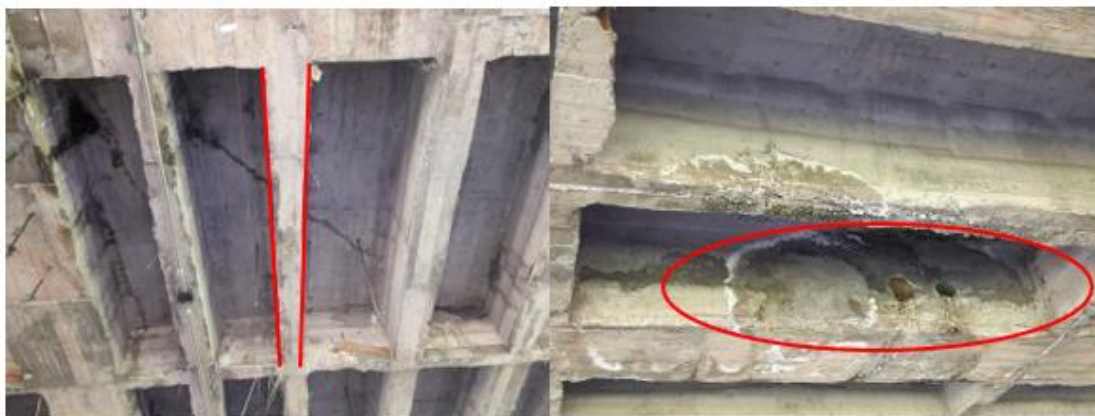
Ilustración 11. Variación de espesores (izq.) y humedad y erosión en viguetas (der.)
