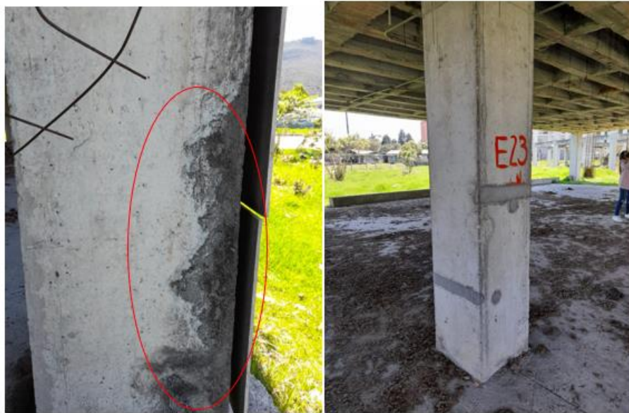
Ilustración 9. Estado de las columnas de la planta inferior
