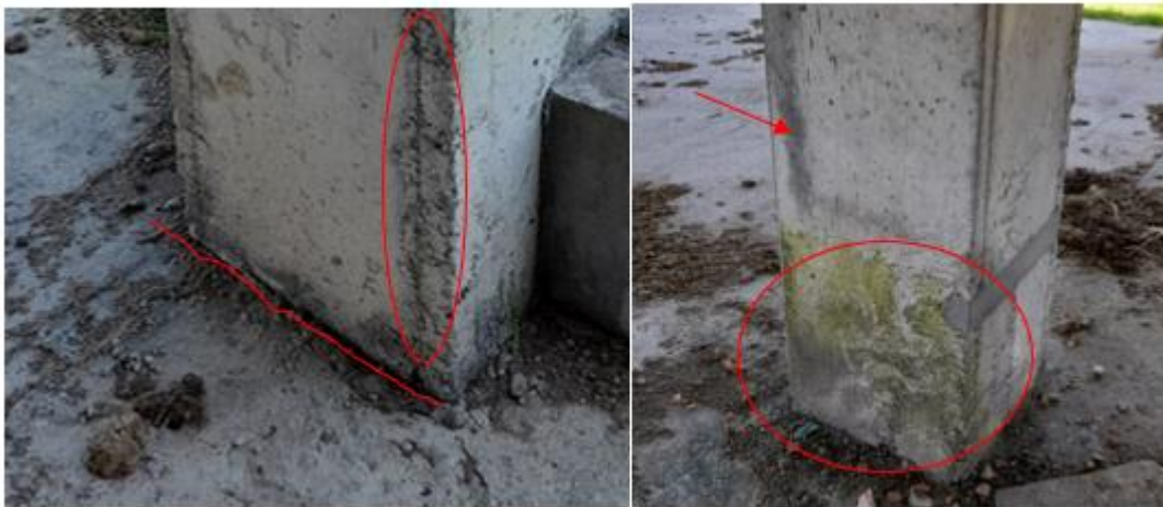
Ilustración 8. Estado de las columnas de la planta inferior
