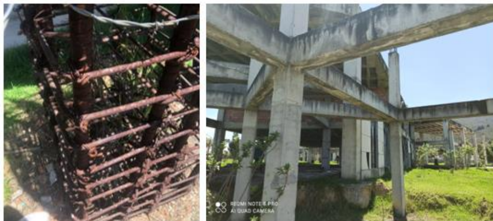
Ilustración 20. Corrosión (izq.) y humedad (der.)
