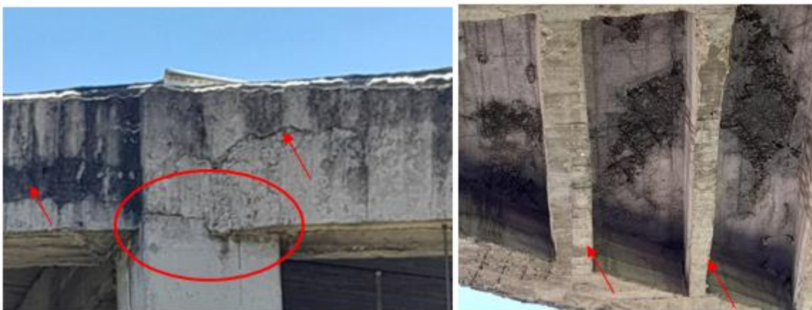
Ilustración 18. Conexión viga columna en cubierta (izq.) y aparición de los aceros de refuerzo (der.)
