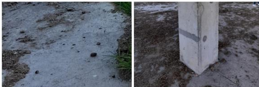
Ilustración 13 Lesiones en placa de concreto del primer piso.
