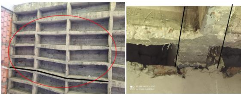
Ilustración 12. Discontinuidad (izq.) y desprendimiento de concreto en viguetas (der.)
