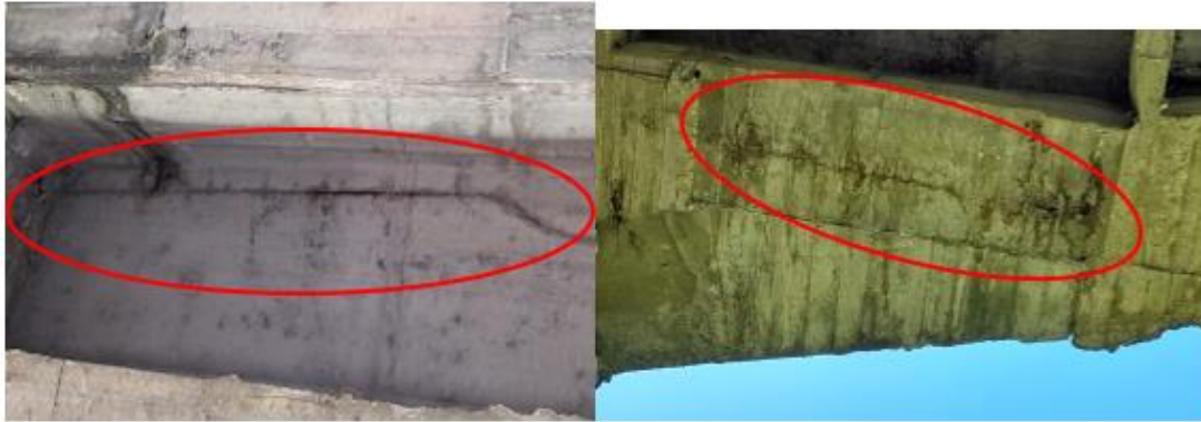
Ilustración 19. Grieta en la parte inferior de la cubierta (izq.). Oxidación y aparición de los aceros de refuerzo (der.)
