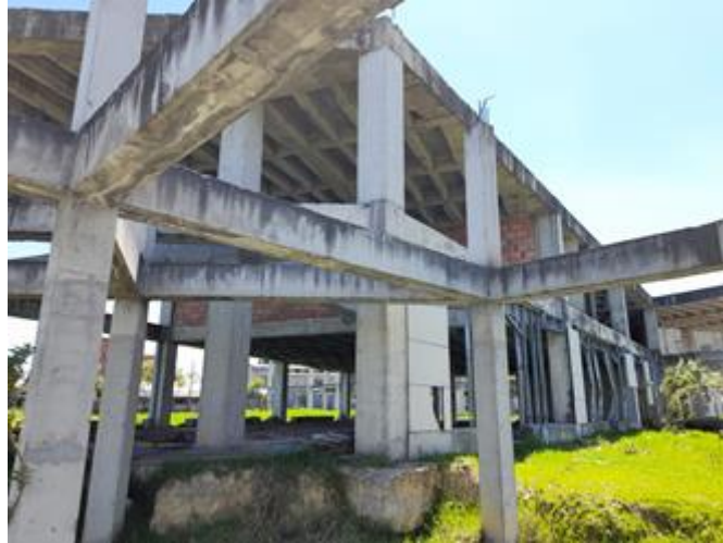
Ilustración 3. Edificación en abandono por parte del contratista
