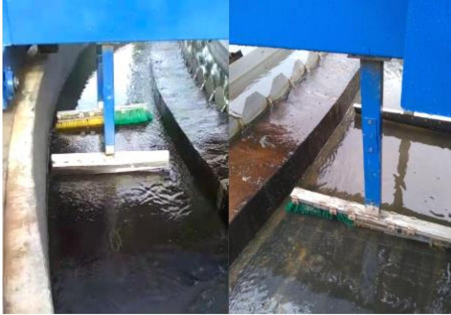
Img. 42 Prototipo instalado en la plata PTAR Fuente: CREACIÓN PROPIA PARA LA PTAR
