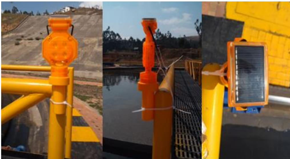
Img. 49 Lámpara de prueba ubicada temporalmente y vista del panel solar que esta lleva. Fuente: Autores
