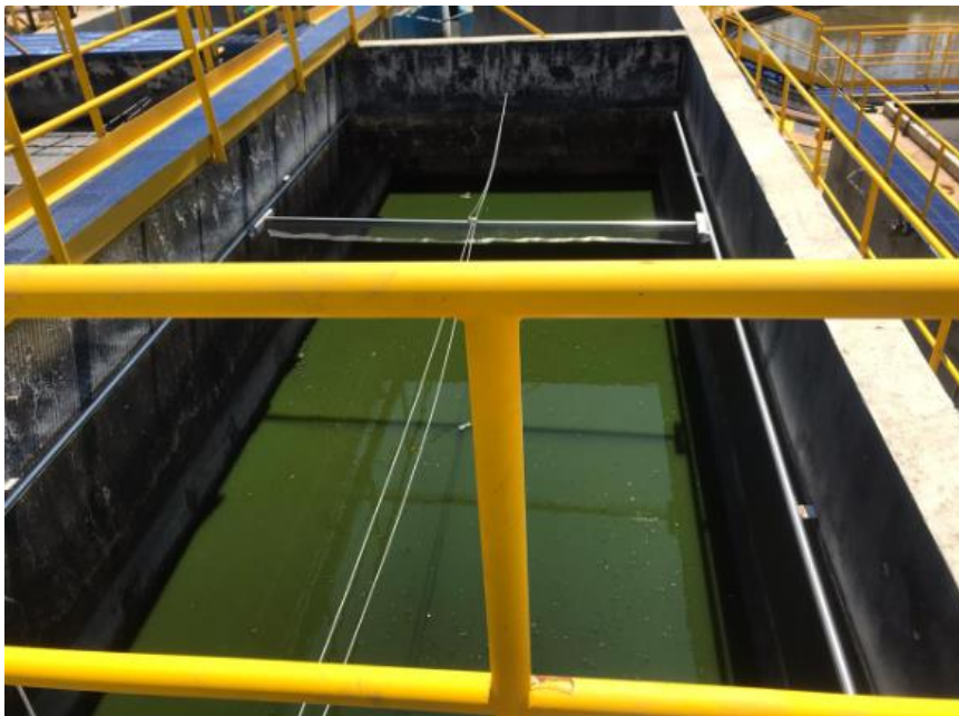
Img.19 Vista del sistema de limpieza y la ubicación en el tanque del módulo 3. Fuente: Autores
