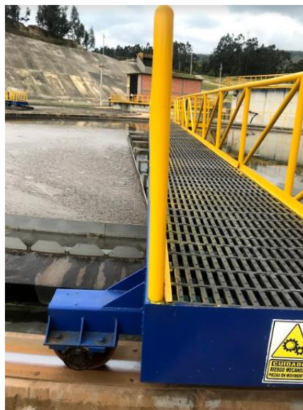
Img. 45 Estructura barrelos del sedimentador donde se espera ubicar la iluminación Fuente: Autores
