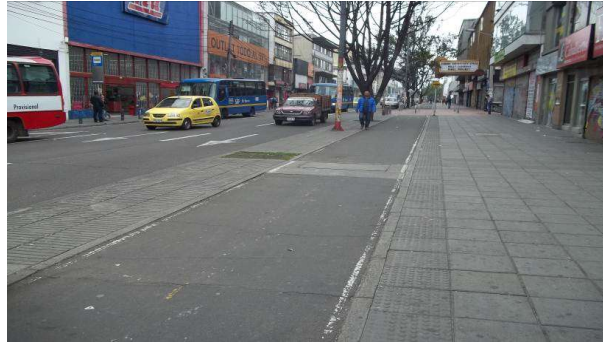
Imagen 18 Fisuras y/o Grietas Transversales, Ciclorruta del Kr 13, sector Chapinero
