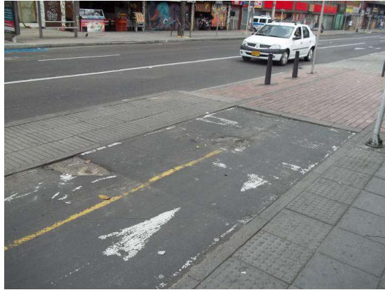
Imagen 20 Baches, existentes en la Ciclorruta de la Kr 13 – Zona Chapinero
