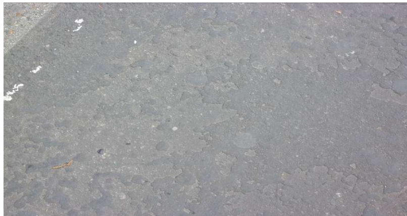
Imagen 19 Descascaramiento capa de Rodadura, presente en la Ciclorruta del Kr 13, sector Chapinero
