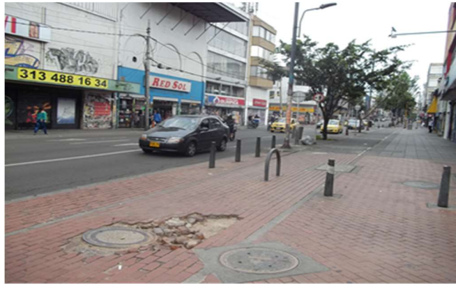
Imagen 21 Baches en la sección de pavimento articulado, presente en la Ciclorruta del Kr 13, sector Chapinero
