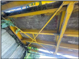
FISURAS, CORROSION LUZ 1- LOSA 1
