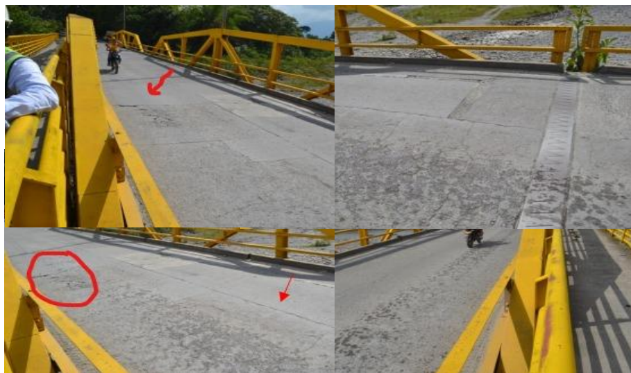
Figura 12 Abrasiones y erosiones en el concreto de la estructura del puente Guamal.
