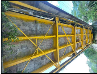
AFLORESCENCIAS LUZ 1- LOSA 4
