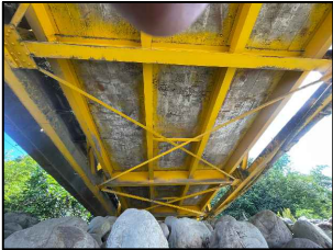
FISURAS, AFLORESCENCIAS LUZ 1- LOSA 3
