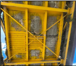
CORROSION, AFLORESCENCIAS LUZ 1- LOSA 5
