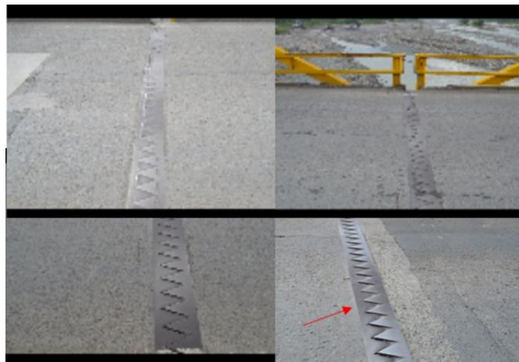
Figura 14 Juntas de dilatación deterioradas.
