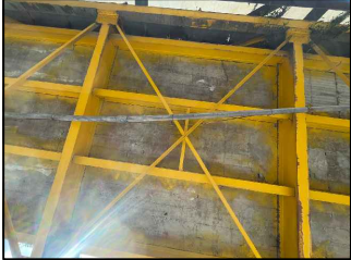
FISURAS, CORROSION LUZ 1- LOSA 6
