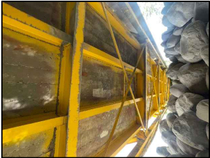
AFLORESCENCIAS LUZ 1- LOSA 1
