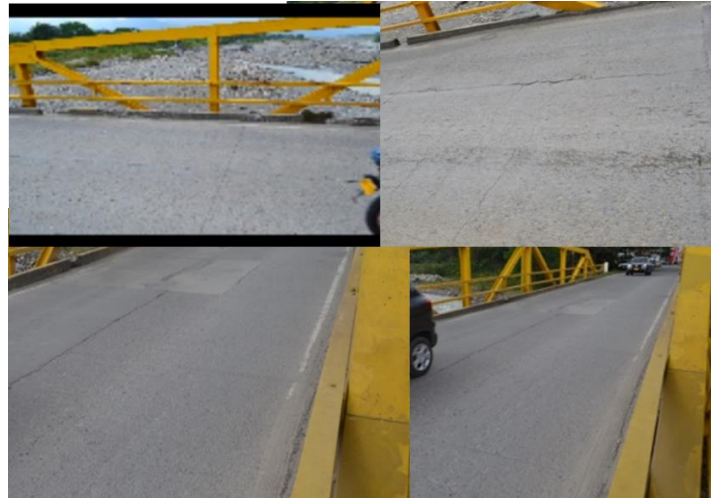
Figura 15 Fisuras en losa del puente.
