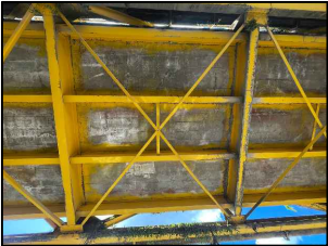
FISURAS, CORROSION, AFLORESCENCIAS LUZ 1- LOSA 2
