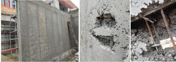
Ilustración 26: Revisión de elementos fundidos.
