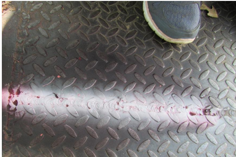
Figura 39. Resultado ensayo tintas penetrantes.
