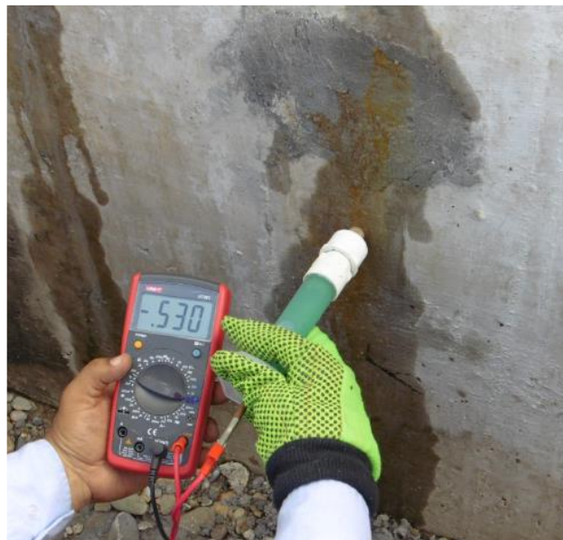
Figura 41. Ensayo 1, estribo puente potencial de corrosión.
