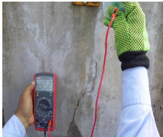
Figura 43. Ensayo 3, estribo puente potencial de corrosión.
