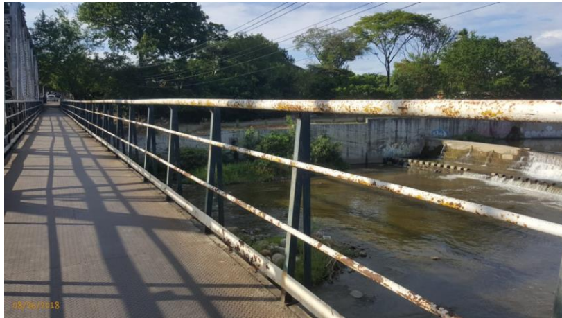
Figura 15. Barandal del puente con presencia de corrosión. Fuente propia
