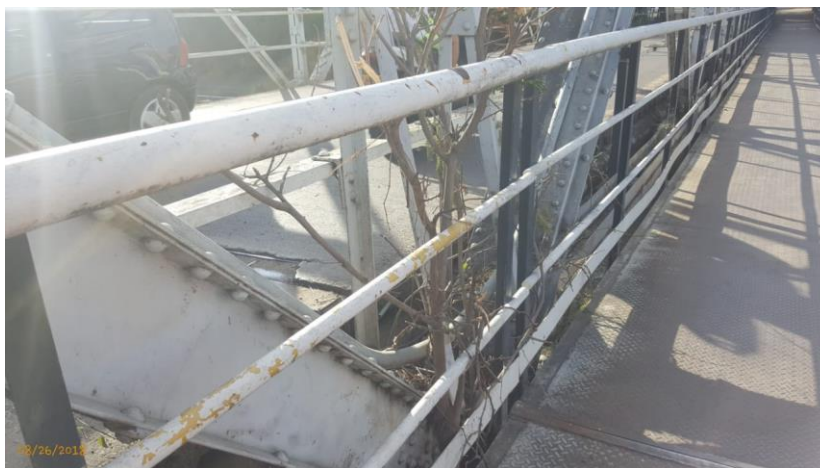
Figura 16. Crecimiento de organismo vegetal (eflorescencia) en componentes del puente. Fuente propia
