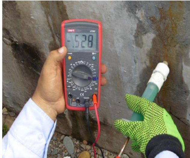
Figura 42. Ensayo 2, estribo puente potencial de corrosión.
