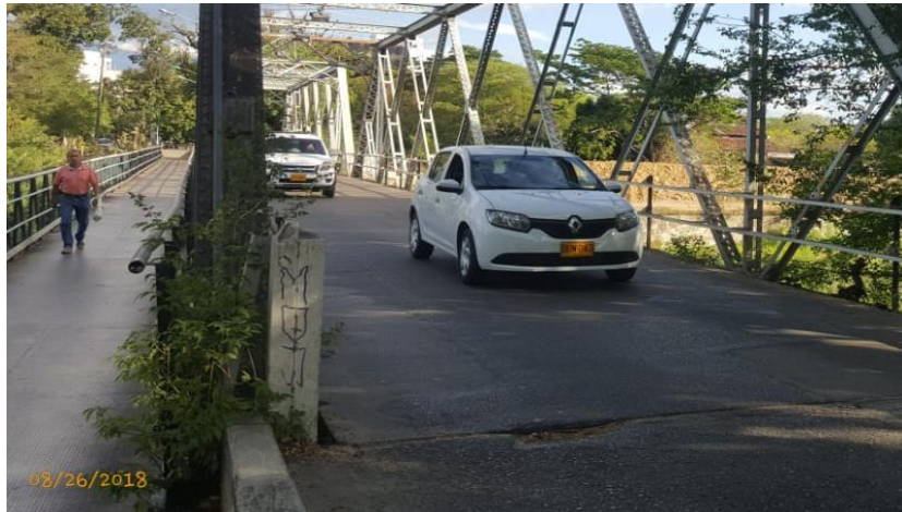
Figura 17. Desfase, desgaste y despique en juntas y dilataciones del puente.
