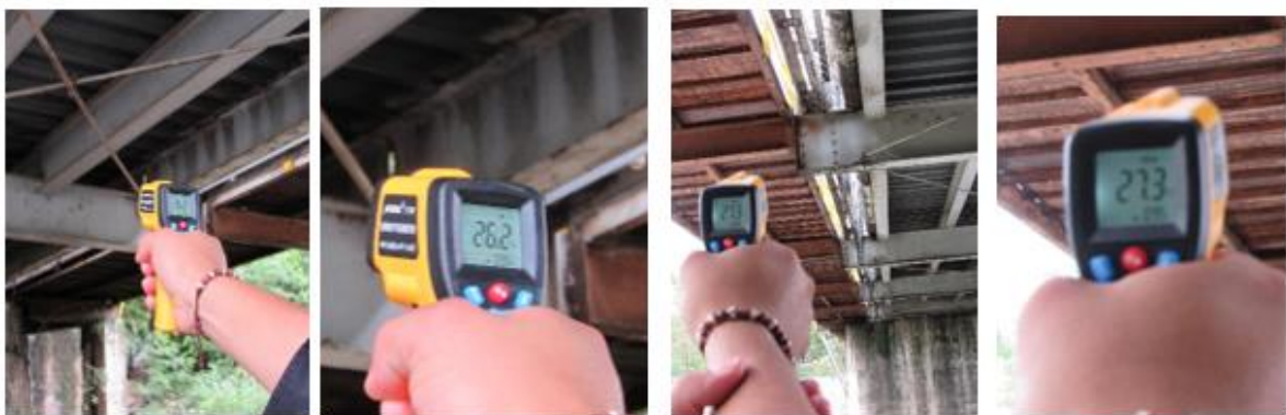
Figura 37. Resultados toma de lecturas con termohigrómetro a vigas metálicas.
