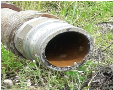
Imagen 16. Tubería pozo profundo
