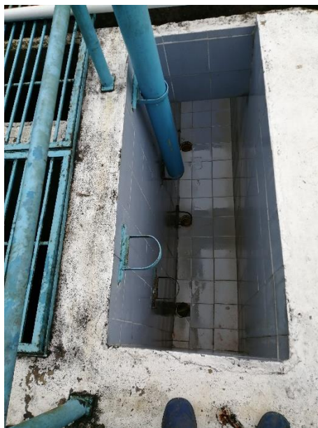
Figura 28 Canal de recolección de agua filtrada. Fuente propia.
