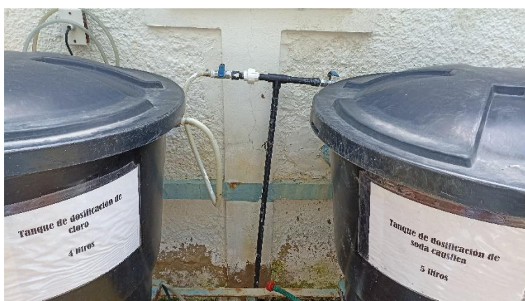
Figura 37 Tanques de dosificación de desinfectante y corrector de pH. Fuente propia.
