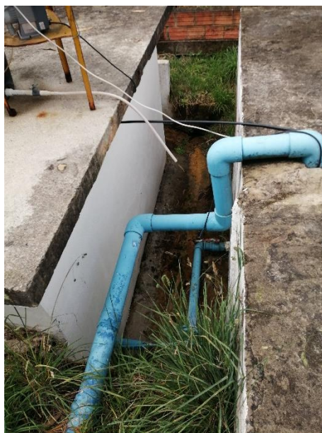
Figura 29 Tubería que conduce el agua filtrada al tanque de almacenamiento. Fuente propia.
