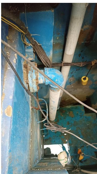
Figura 39 Tanque de almacenamiento. Fuente propia.
