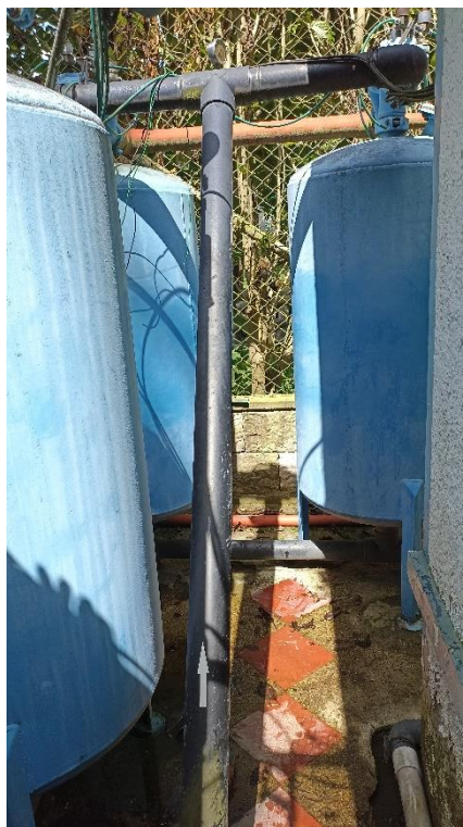
Figura 35 Tanques de filtración. Fuente propia.
