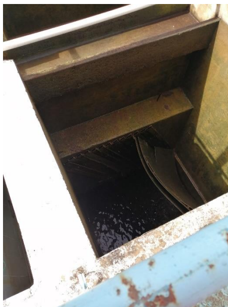
Figura 24 Módulo de decantación y canal de transporte de agua sedimentada. Fuente propia.
