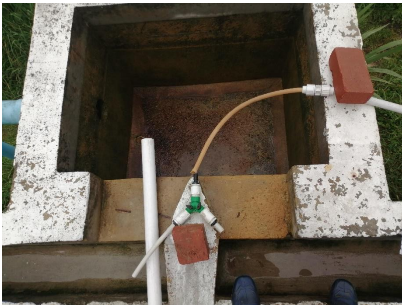
Figura 21 Entrada de agua cruda. Fuente propia.
