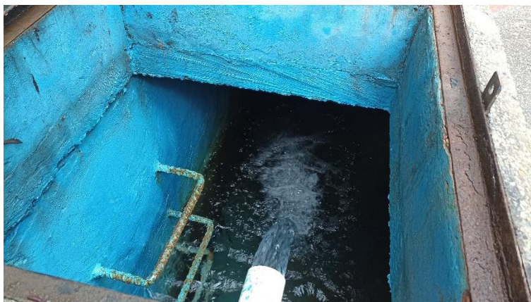
Figura 38 Tanque de almacenamiento. Fuente propia.
