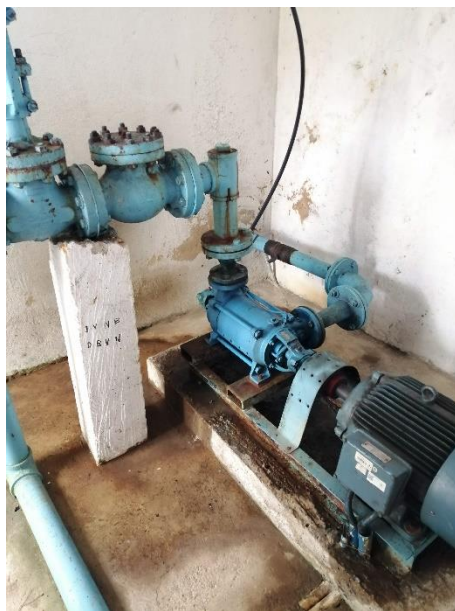
Figura 33 Cuarto de máquinas. Fuente propia.
