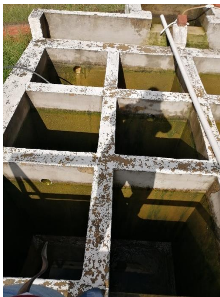
Figura 22 Floculadores de flujo vertical. Fuente propia.
