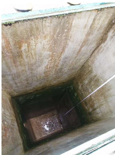
Figura 27 Cámara de agua filtrada. Fuente propia.
