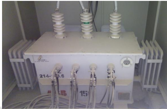
Figura 45. Transformador de 150 KVA. Campus, tomada por el Autor.
