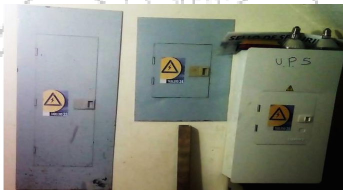
Figura 6. Cajas de circuitos cuarto técnico. Recepción, tomada por el Autor.
