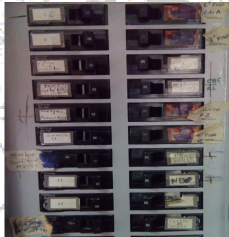
Figura 21. Caja de circuitos, breaker con rotulado provisional, tablero 11, tomada por el Autor.
