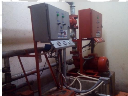
Figura 31. Cuarto de Motobombas, tomada por el Autor.
