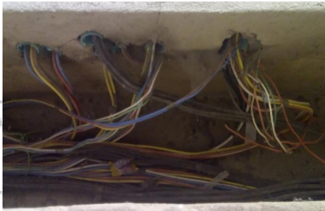
Figura 60. Cableado en condiciones de exposición de polvo y basura. Campus, tomada por el autor
