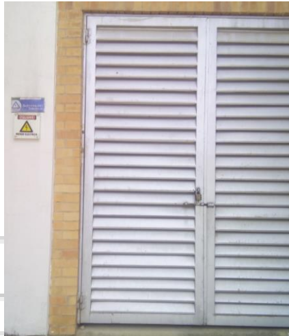
Figura 43. Subestación eléctrica, sede Campus, tomada por el Autor.
