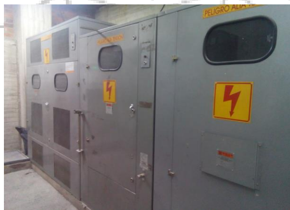
Figura 39. Seccionadores y transformador Subestación, tomada por el Autor
