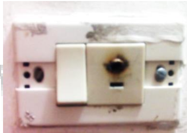
Figura 14. Riesgo eléctrico por corto en toma corriente, tomada por el Autor.
