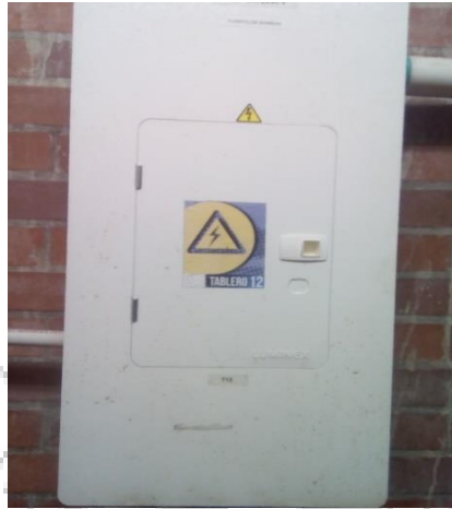
Figura 33. Tablero de distribución. Cuarto de Motobombas, tomada por el Autor.
