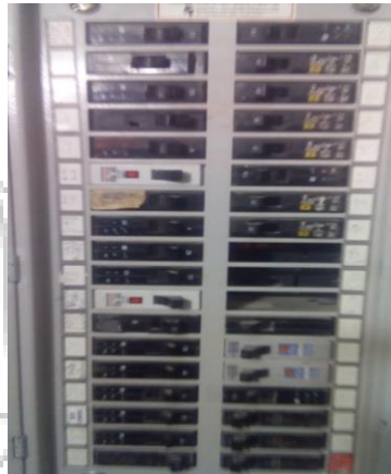
Figura 7. Caja de circuitos 1, composición y estructura interna, tomada por el Autor.
