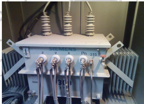
Figura 41. Transformador de 300 KVA, SIEMENS, tomada por el Autor.
