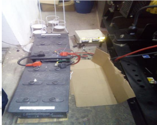
Figura 37. Elementos inapropiados dentro del cuarto de planta física, tomada por el Autor.
