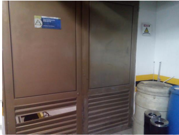
Figura 38. Subestación Universidad Santo Tomás. Centro, tomada por el Autor.
