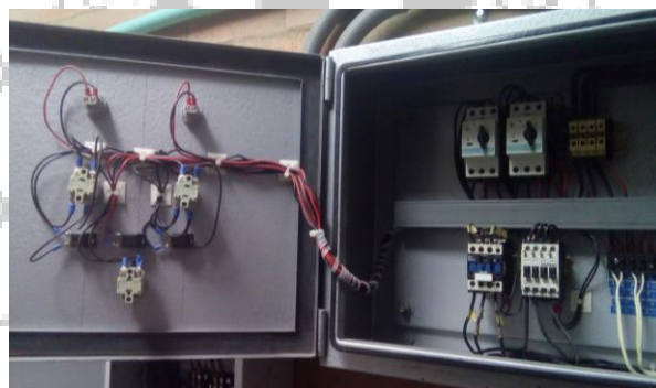
Figura 25. Instalación eléctrica de tablero de control, tomada por el Autor.
