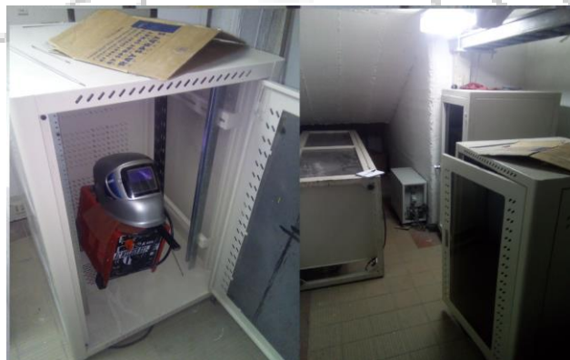
Figura 27. Instalaciones cuarto técnico de garaje. Riesgo locativo, tomada por el Autor.
