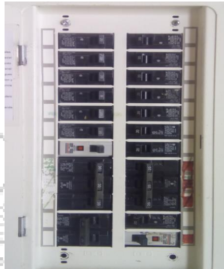
Figura 49. Tablero de Fuerza Laboratorio y Modulo 6. Campus, tomada por el Autor.
