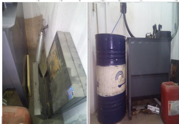
Figura 30. Instalaciones cuarto Máquina Ascensor, tomada por el Autor.
