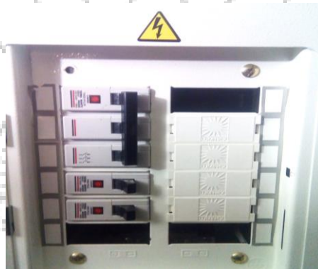
Figura 10. Caja de circuitos 3, composición y estructura interna, tomada por el Autor.
