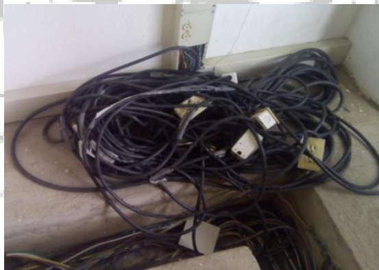
Figura 51. Riesgo locativo, Cuarto Técnico Campus, tomada por el Autor.
