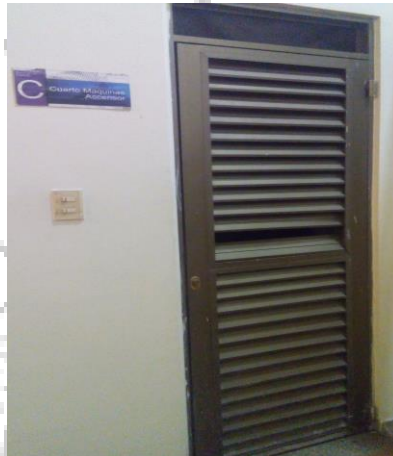
Figura 28. Cuarto Maquinas Ascensor, tomada por el Autor.
