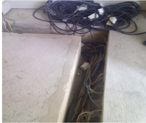
Figura 52. Cableado sin almacenamiento y conservación adecuado, tomada por el Autor.
