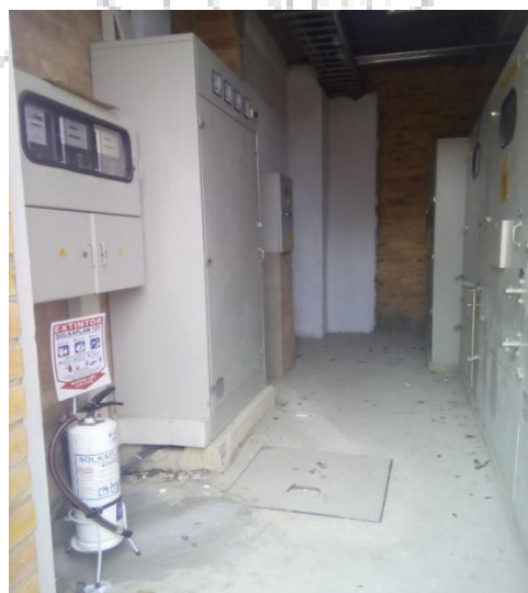
Figura 46. Instalaciones de subestación eléctricas. Campus, tomada por el Autor.
