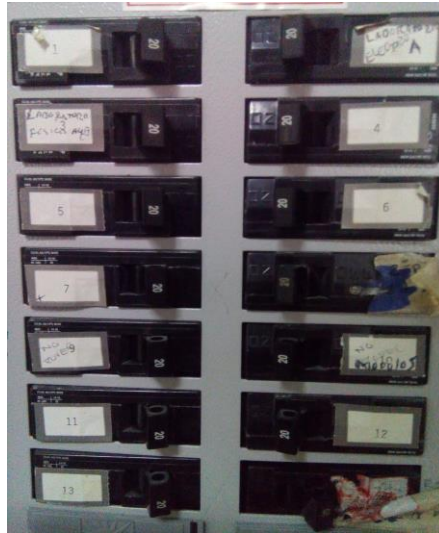
Figura 20. Caja de circuitos, Breaker con rotulado provisional, tablero 9, tomada por el Autor.
