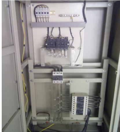
Figura 50. Tablero General de Emergencia, tomada por el Autor.
