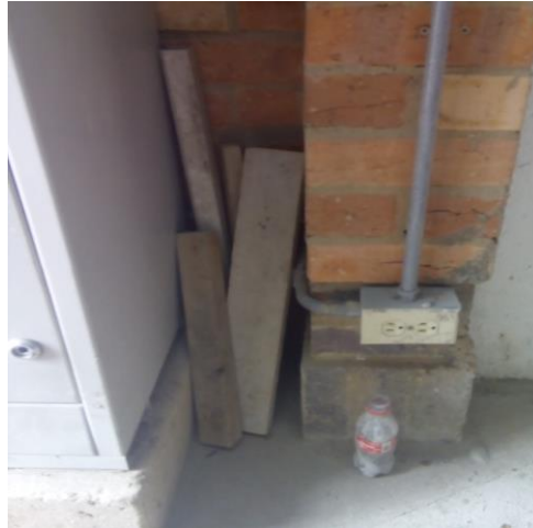
Figura 47. Objetos de madera, no aptos dentro de Subestación. Campus, tomada por el Autor.
