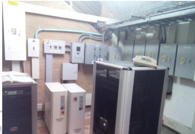
Figura 22. Instalaciones cuarto técnico sector gimnasio, tomada por el Autor.
