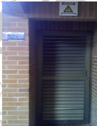
Figura 17. Puerta de ingreso cuarto técnico ubicado en el sector del gimnasio, tomada por el Autor.
