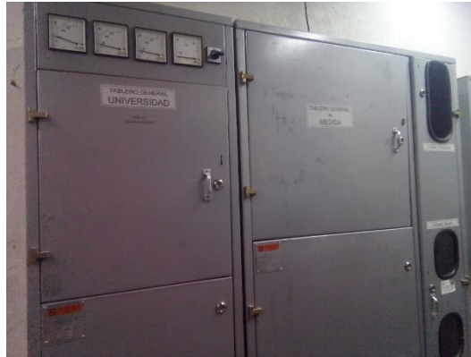
Figura 42. Tablero general de medida. Universidad Santo Tomas, tomada por el Autor.
