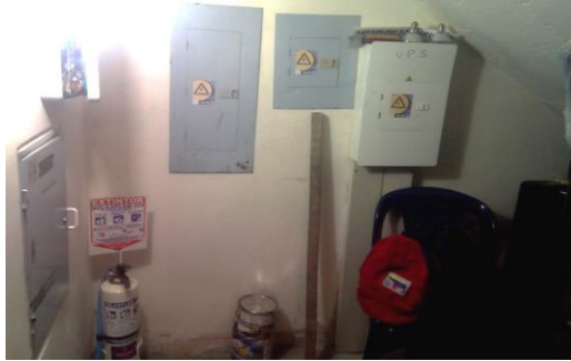
Figura 11. Cuarto técnico sector recepción, tomada por el Autor.
