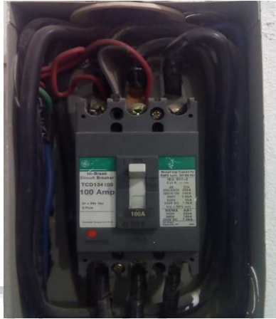
Figura 29. Breaker de protección a 100 A, tomada por el Autor.
