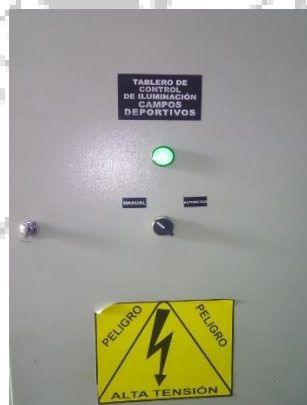
Figura 44. Tablero de control, escenarios deportivos, tomada por el Autor.
