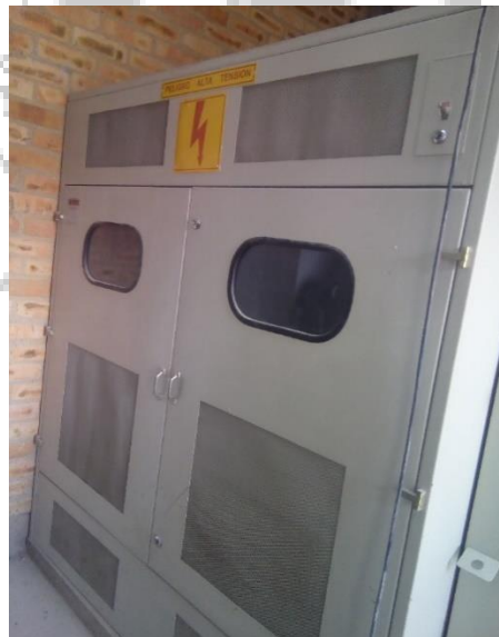
Figura 48. Carcasa aislante de transformador a 150 kVA, tomada por el Autor.
