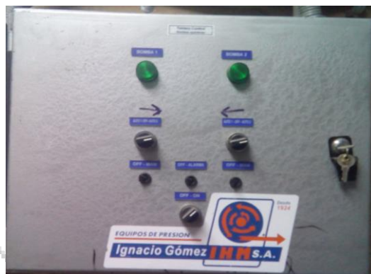
Figura 24. Tablero de control de motobomba, tomada por el Autor.
