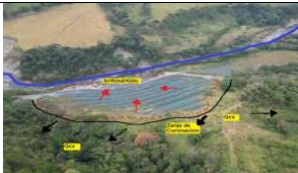
Fotografía 52. SubTramo PR86+900 - PR87+200, Qcx), Se evidencia deslizamiento, deposito coluvial de diferentes tiempos. Contratista para mitigar realiza zanja de coronación, talud con terracedo, instalación de tensores, con malla galvanizada y geomembrana.
