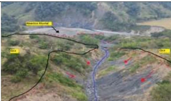
Fotografía 51. SubTramo PR86+300 - PR86+600, Qcx), depósitos o geoformas coluviales de diferentes tiempos, Se evidencia socavación y ensanchamiento del canal natural del cuerpo hídrico.
