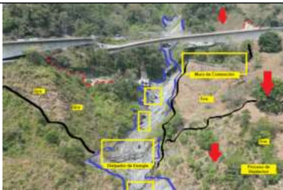
Fotografía 45. Sub Tramo PR81+100 - PR81+300 (Parte Inferior de la Vía): Se evidencia muro de contención, conforme al proceso de reptación se observa que tuvo un desplazamiento considerable al igual que la base occidental del puente los grillos; generando el Colapso mismo.
