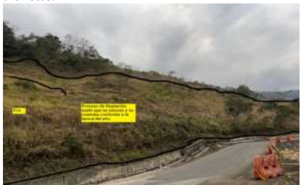
Fotografía 50. SubTramo PR85+000 - PR85+300, Se evidencia proceso de reptación, debido a cambios estacionales de lluvia y temperatura, las lutitas presentan, hinchamiento y contracción, provocando el empuje y desplazamiento de tierras.
