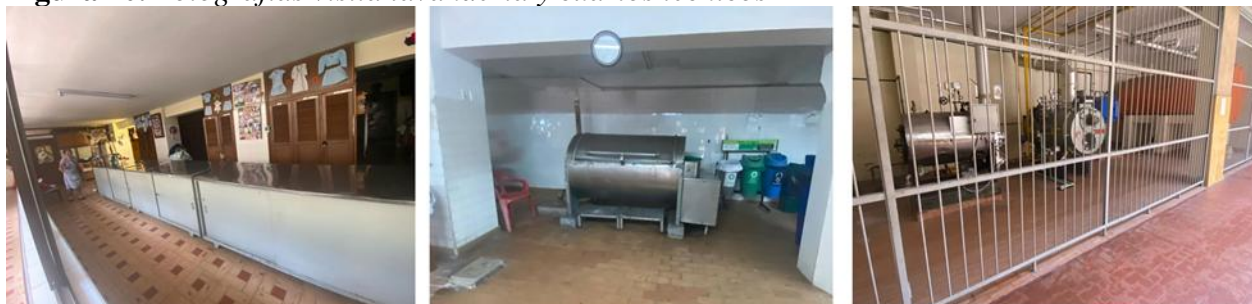
Figura 70. Fotografías visita lavandería y cuartos técnicos
