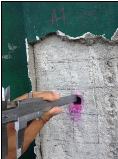
7 Columna A1 – Segundo Piso Frente de Carbonatación = 14mm
