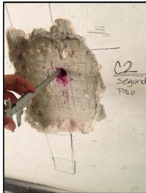
8 Columna C2 – Segundo Piso Frente de Carbonatación = 12mm
