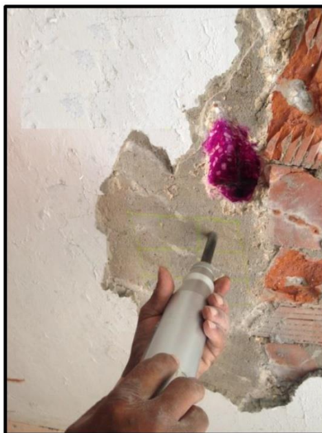
Placa entre B3 – B4 – Tercer piso
