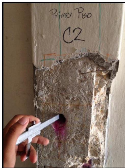
2 Columna C2 – Primer Piso Frente de Carbonatación = 37,5mm
