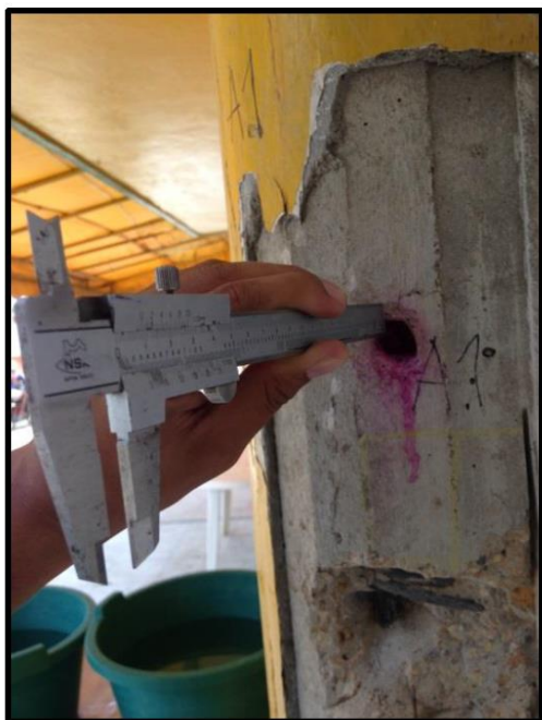
1 Columna A1 – Primer Piso Frente de Carbonatación = 9mm
