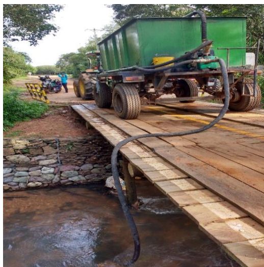
Fig.1. Foto del Sistema de captación por "agua móvil"
