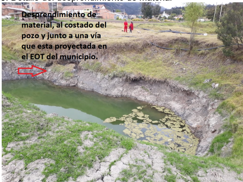
Ilustración 13. Detalle del desprendimiento de material
