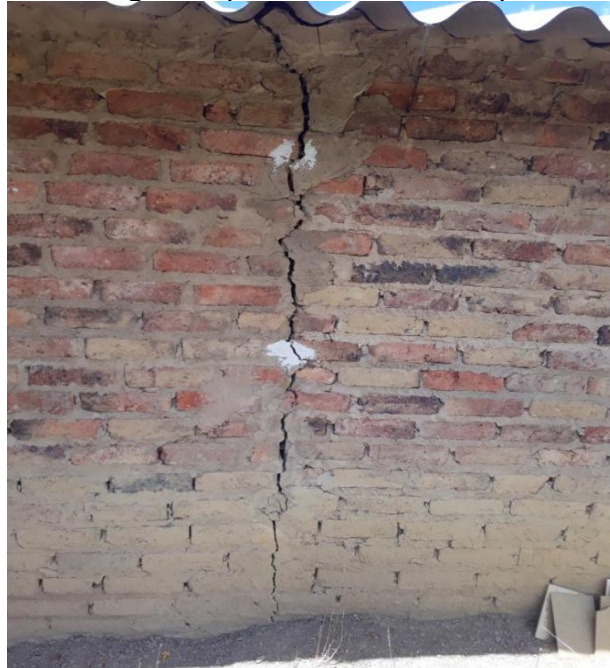
Ilustración 16. Grieta con un grosor pronunciado, en la parte trasera de la vivienda.
