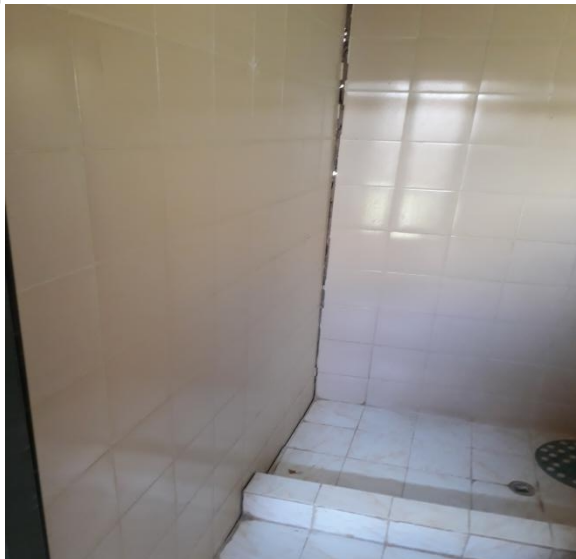
Ilustración 15. Grieta presente en el baño de la vivienda
