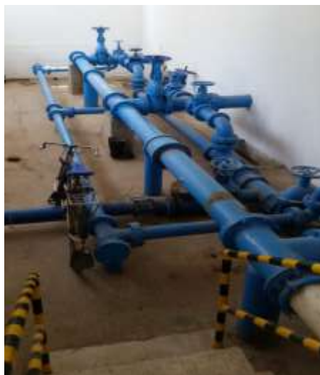
Imagen 17. Cuarto de válvulas
