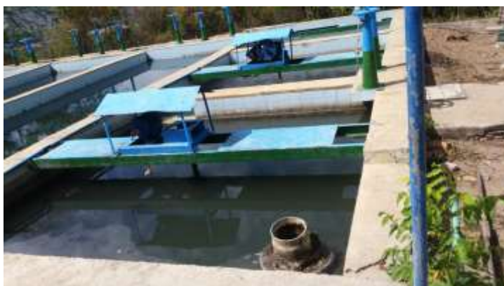
Imagen 13. Tanques de coagulación
