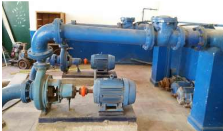
Imagen 23. Cuarto de bombas
