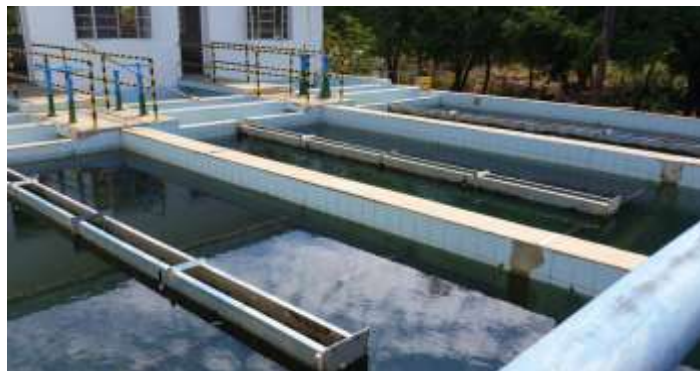
Imagen 15. Canales de salida del sedimentador
