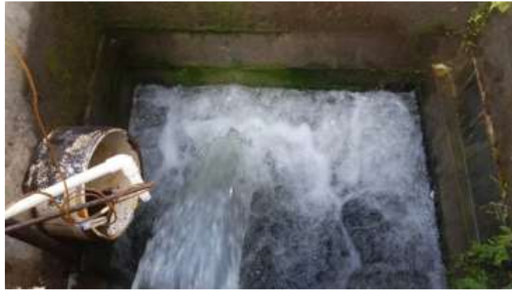
Imagen 7. Entrada a la planta, Dosificación
