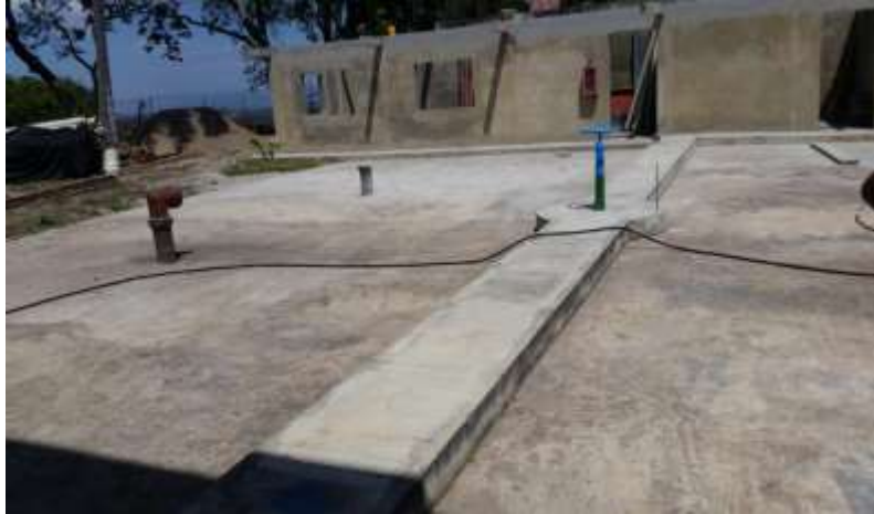
Imagen 22. Tanques de almacenamiento enterrados
