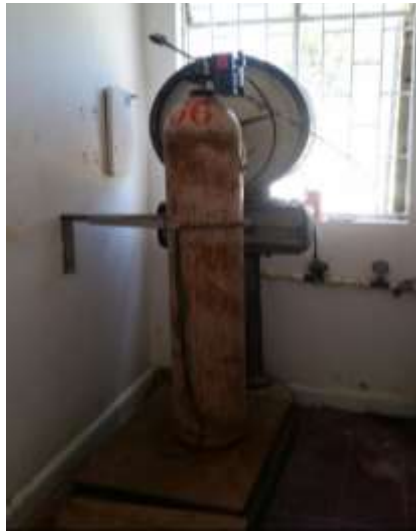
Imagen 18. Tanque Cloro Gaseoso
