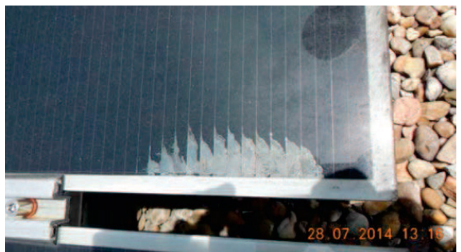
Figura 9. Corrosión en un módulo fotovoltaico de capa fina
