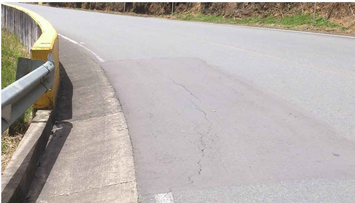
Fotografía 14. Fisura de media luna y parcheo PR19+0628. Fuente: de este estudio – 2017
