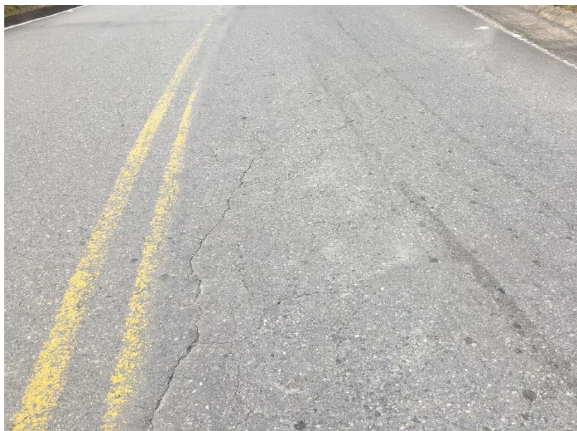
Fotografía 3. Fisura longitudinal PR19+0590. Fuente: de estudio 2017
