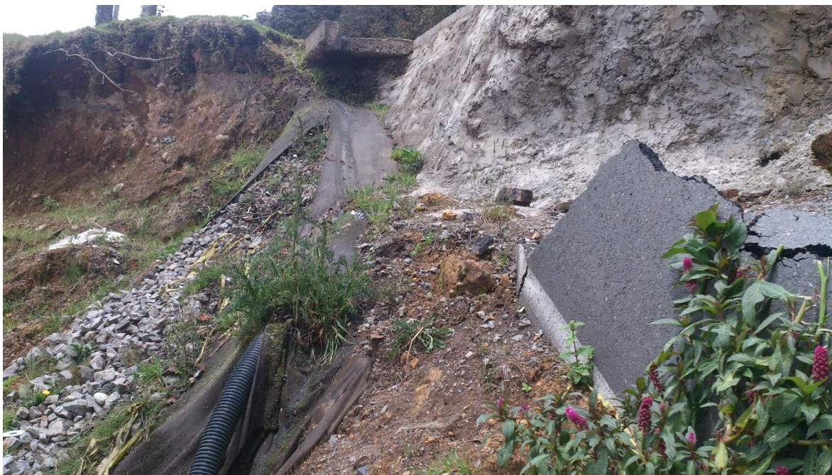
Fotografía 13. Filtro tipo francés, bajo la cuneta margen derecha y bajo la estructura de confinamiento PR19+0617. Fuente: de este estudio – 2017
