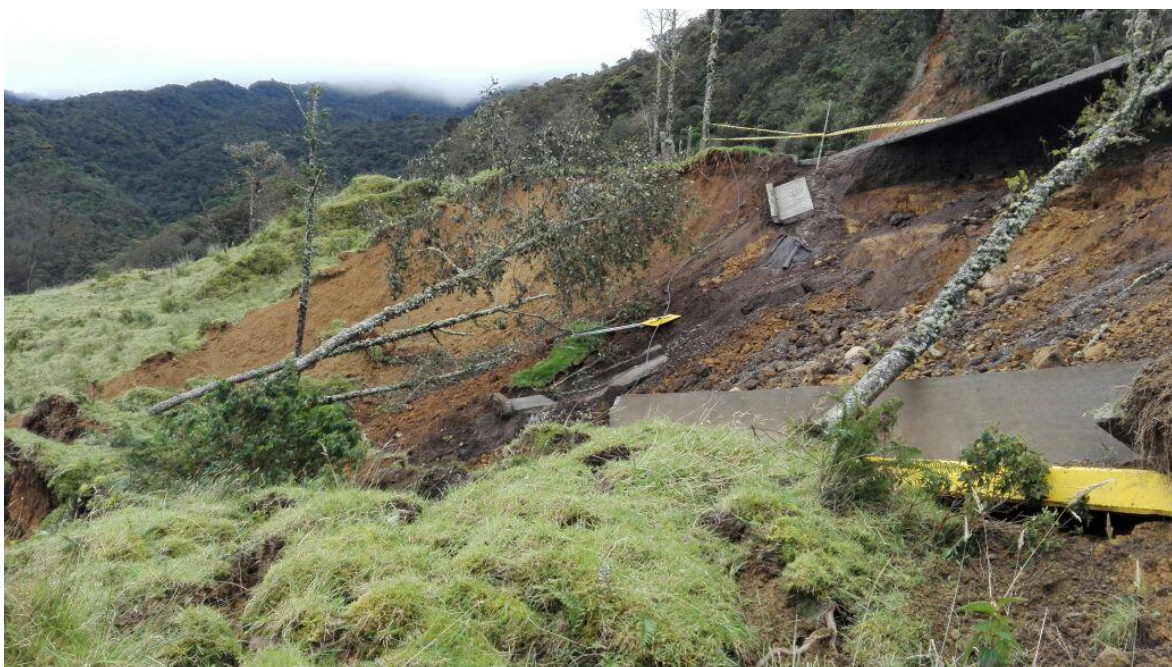
Fotografía 6. Colapso estructura de confinamiento y pérdida de banca PR19+0600. Fuente: de este estudio – 2017
