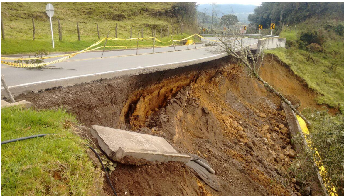
Fotografía 5. Colapso estructura de confinamiento y pérdida de banca PR19+0590 Fuente: de este estudio – 2017
