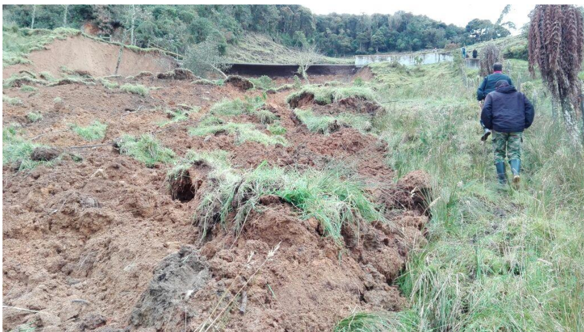
Fotografía 7. Deslizamiento, vista desde la pata del talud inferior PR19+0620. Fuente: de este estudio – 2017
