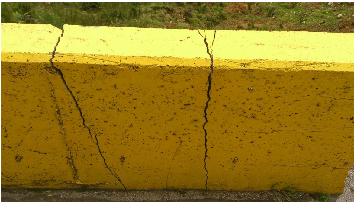
Fotografía 16. Grietas en estructura de confinamiento PR19+0621. Fuente: de este estudio – 2017
