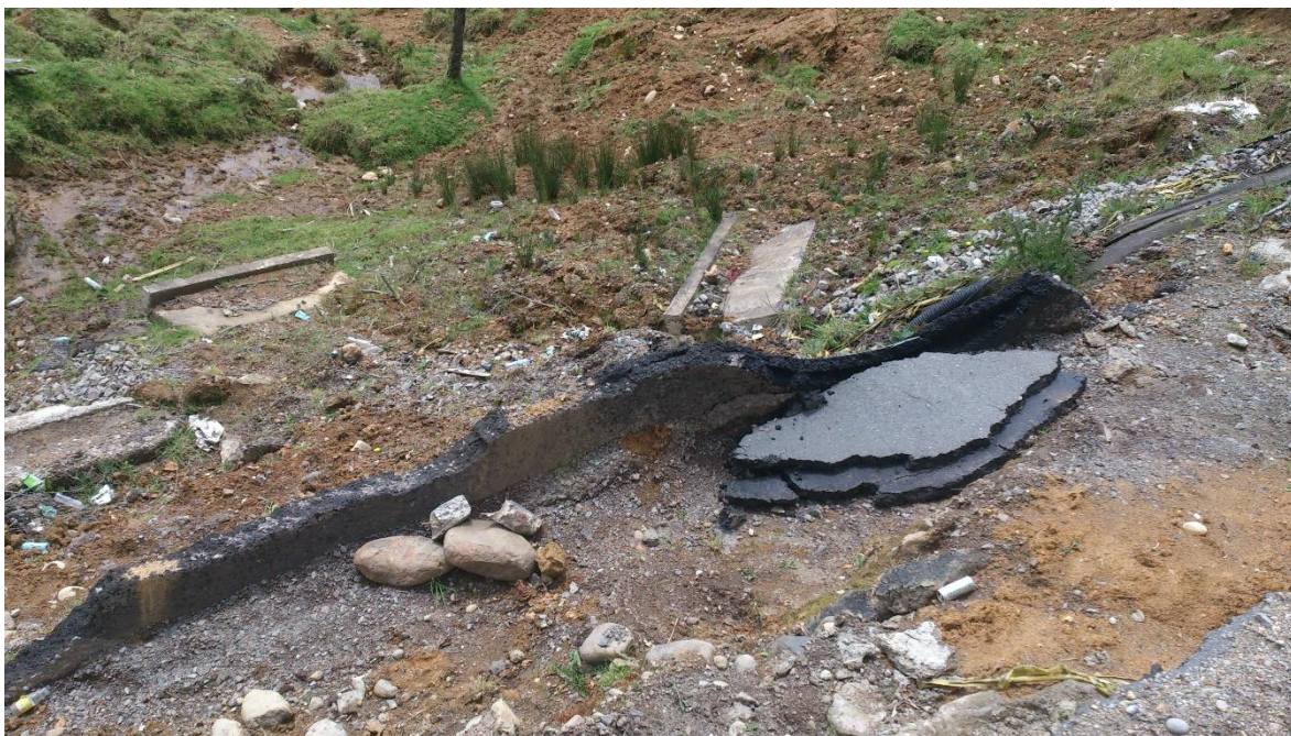
Fotografía 9. Colapso estructura de confinamiento y carpeta asfáltica PR19+0600. Fuente: de este estudio – 2017
