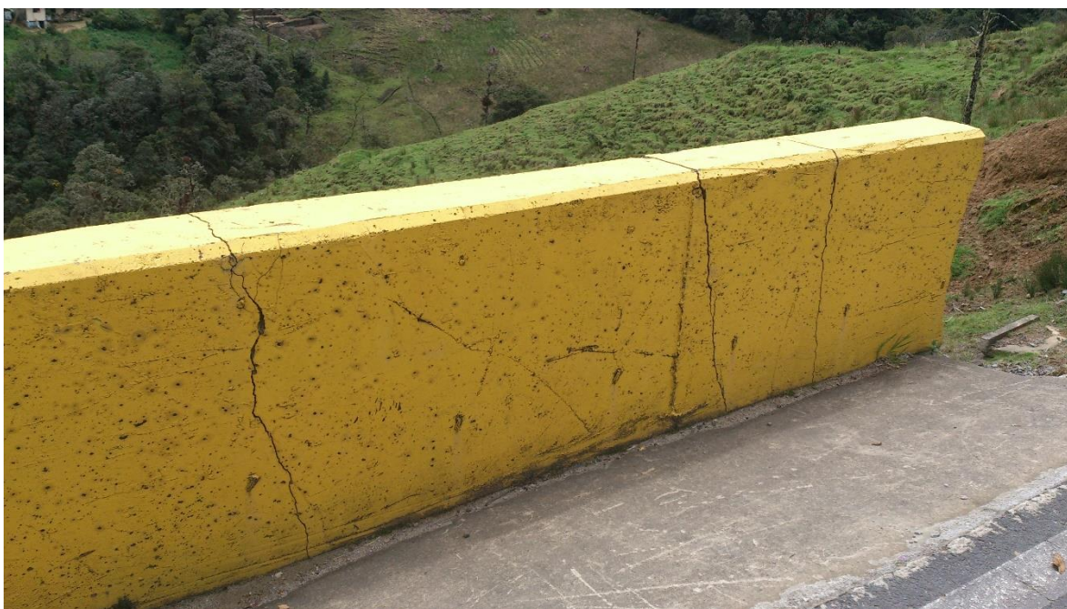
Fotografía 15. Grietas en estructura de confinamiento PR19+0621. Fuente: de este estudio – 2017
