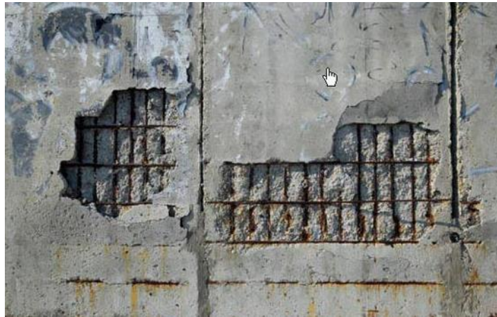
Figura 14: Ejemplo de pérdida del recubrimiento.
