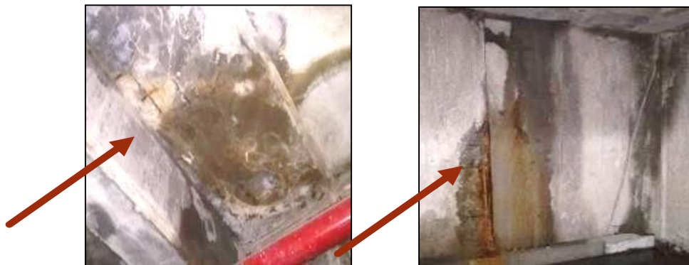
Figura 12: Filtración, humedad y corrosión del refuerzo expuesto en Sótano 3. Fuente: Propia.
