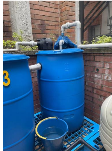
Imagen 31. Tanque de desinfección
