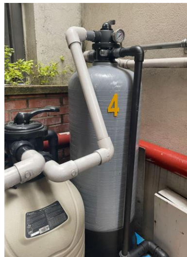
Imagen 33. Filtro de carbón activado
