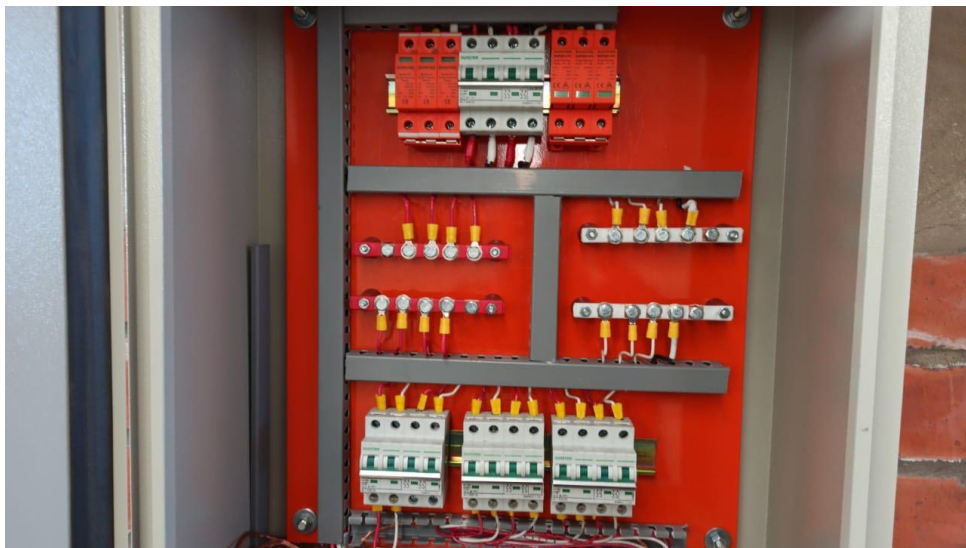
Imagen 22. Tablero de control y protecciones. Fuente equipo técnico Enercer
