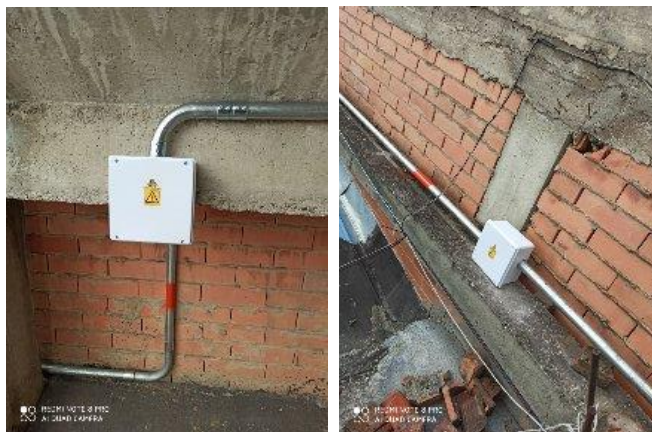
Imagen 13 y 14. Puestas de cajas de paso. Fuente equipo técnico Enercer.
