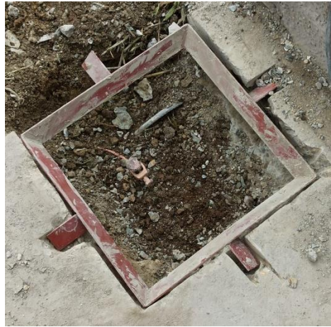
Imagen 17. Instalaciones de tierra. . Fuente equipo técnico Enercer
