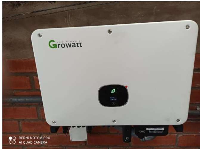
Imagen 23. Inversor 50kW. Fuente equipo técnico Enercer
