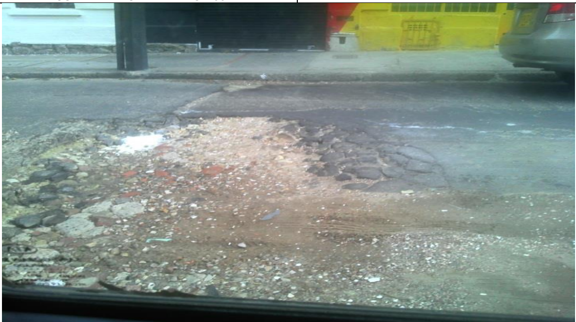
EL MAL ESTADO DE LA MALLA VIAL DIFICULTA LA MOVILIDAD. CORREDOR CALLE 66
