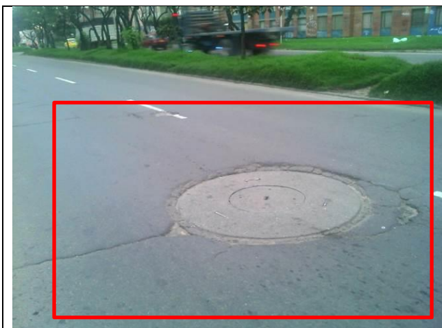
Estado deficiente de la malla vial (CI 72 x Cr 104a).
