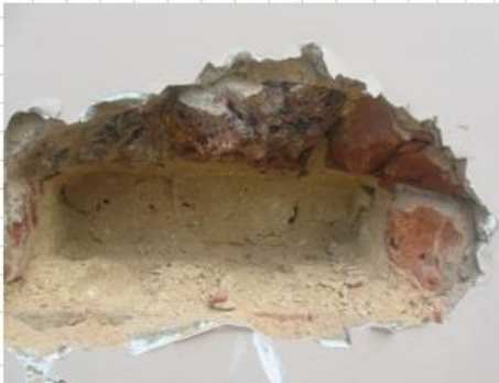
Ilustración 10: Muro de mampostería en ladrillo recocido, sin ningún tipo de refuerzo
