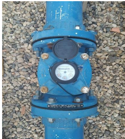
Ilustración 1. Macro medidor salida Núcleo Urbano II
