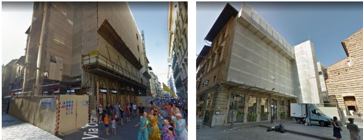
Figura 9. Protecciones en andamios a los usuarios del espacio público en Florencia, Italia. Fuente: Google maps
