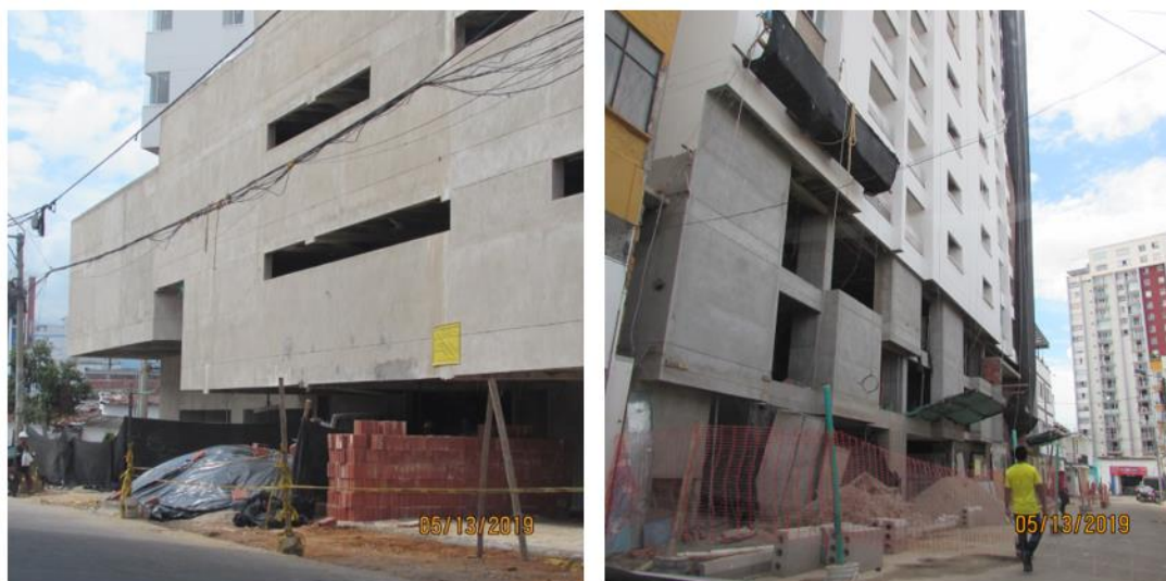
Figura 72. Obstrucción del espacio público por materiales vinculados a la obra. Fuente: Autor
