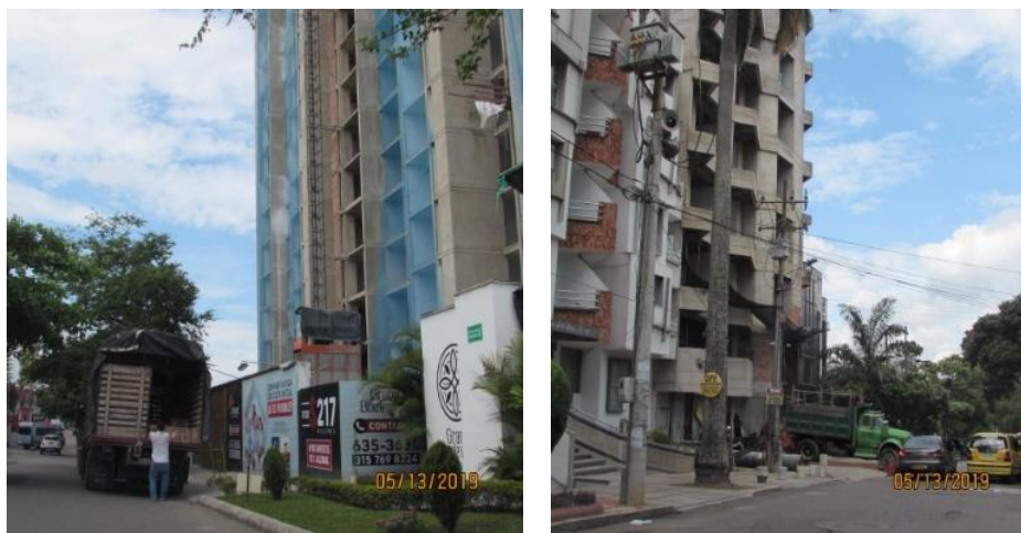
Figura 33. Obras sin señalización temporal de vías.
