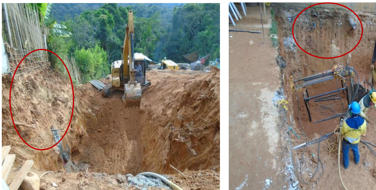
Figura 31. Excavaciones adelantadas sin obras de estabilización provisional.
