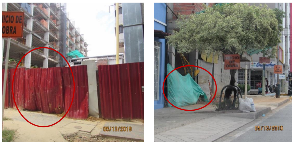
Figura 37. Inadecuada implementación del cerramiento temporal.
