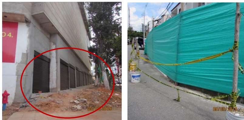
Figura 48. Se garantiza la accesibilidad del peatón o se adecua una segura circulación.
