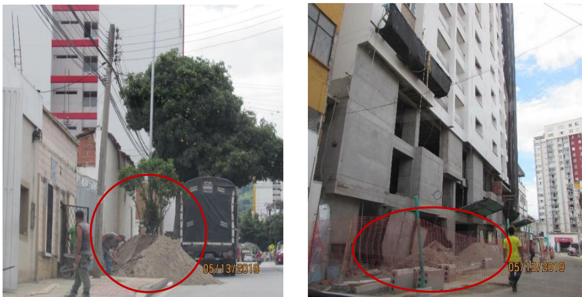
Figura 43. Invasión del espacio público con materiales relacionados con la obra.
