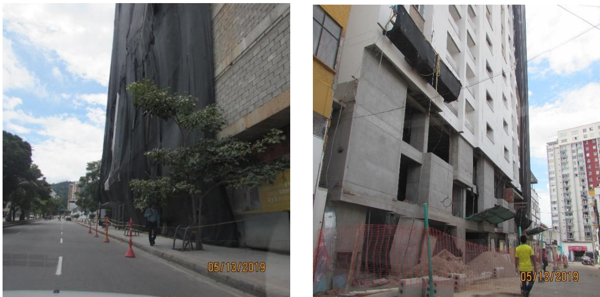
Figura 70. Inadecuada implementación de bandejas y mallas de protección.
