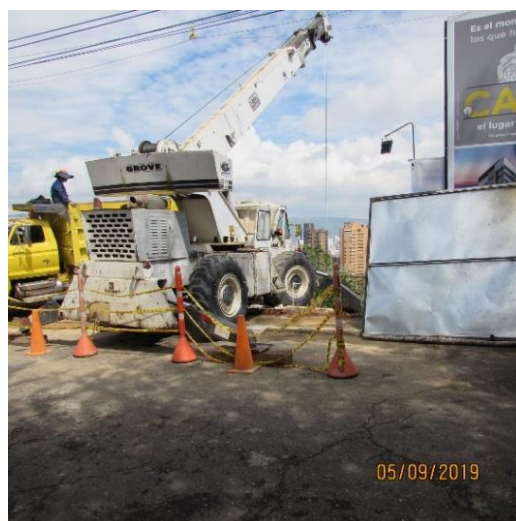
Figura 64. Obra en etapa de excavación no presenta implementa cerramiento provisional.
