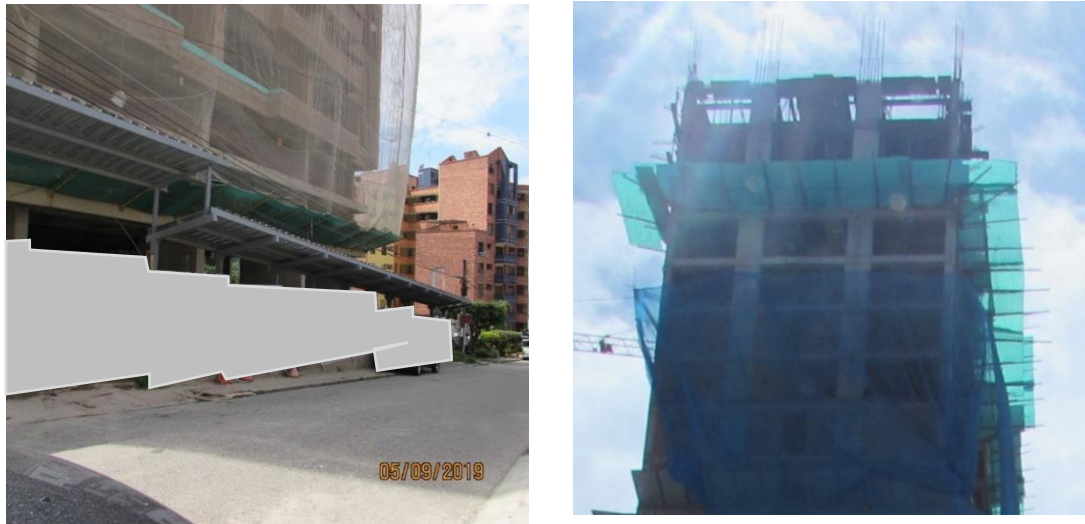
Figura 69. Adecuada implementación de mallas y bandejas de protección.
