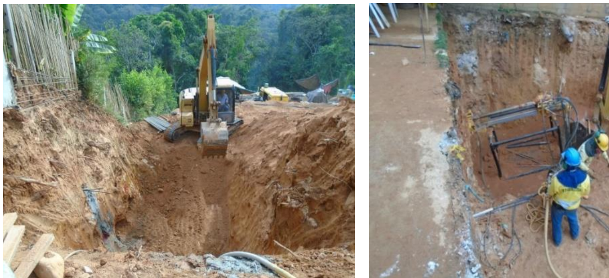
Figura 60. Evidencia de infracciones durante la etapa de movimiento de tierras y excavaciones.
