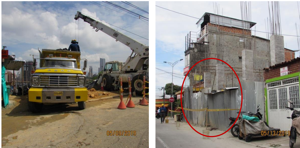
Figura 35. Cerramiento provisional mal ubicado o inexistente. Fuente: Autor.
