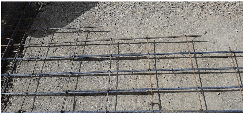
Ilustración 29 Acero en esquina de sobrancho
