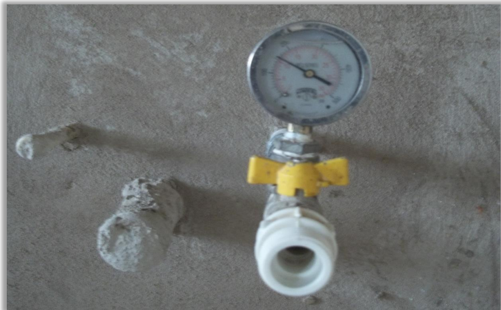
IMAGEN 10. Medidor de presión (manómetro)
