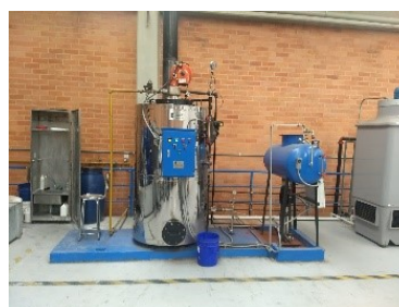
Caldera de gas
