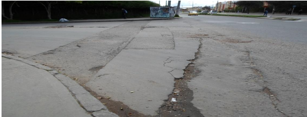
Figura 24. Bache (BCH), Abultamiento (AB), Parche (PCH). Severidad: Alta.
