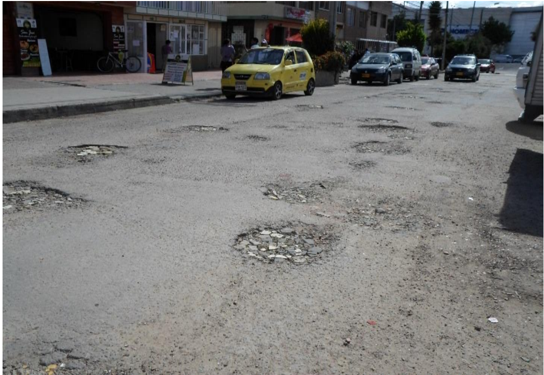
Figura 30. Bache (BCH), Descascaramiento (DC), Cabezas duras (CD), Ondulaciones (OND) y Pérdida de Agregado (PA). Severidad: Alta.
