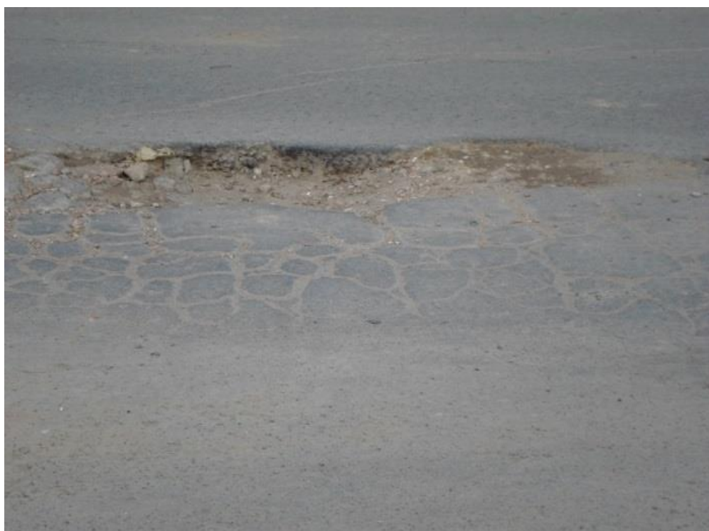
Figura 39. Hundimiento (HUN) y Fisuras en Bloque (FB). Severidad: Alta.
