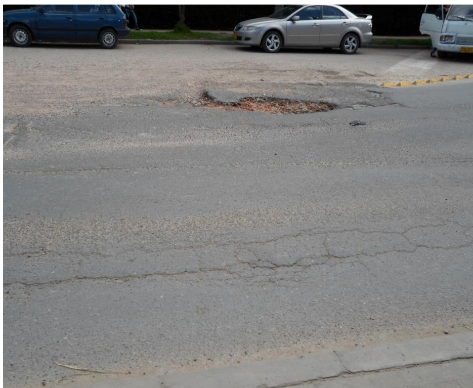
Figura 21. Bache (BCH), Piel de cocodrilo (PC). Severidad: Alta.
