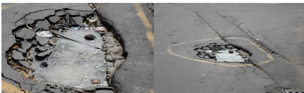
Figura 29. Descascaramiento (DC), Fisuras por Juntas de Construcción, presencia de agua y materia orgánica. Severidad: Alta.
