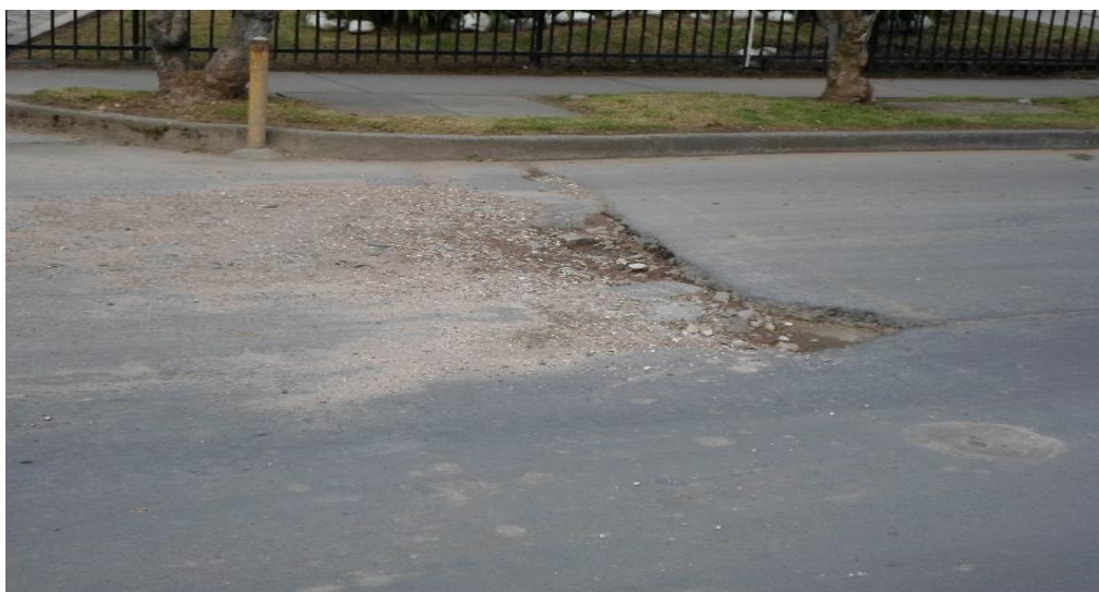
Figura 27. Hundimiento (HUN) y Afloramiento de Finos (AFI). Severidad: Alta
