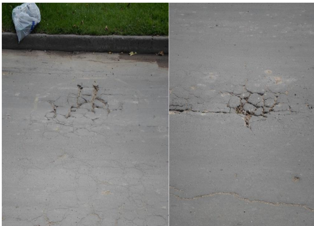
Figura 38. Fisuras en Bloque (FB), Fisuras (FL, FT). Severidad: Alta.
