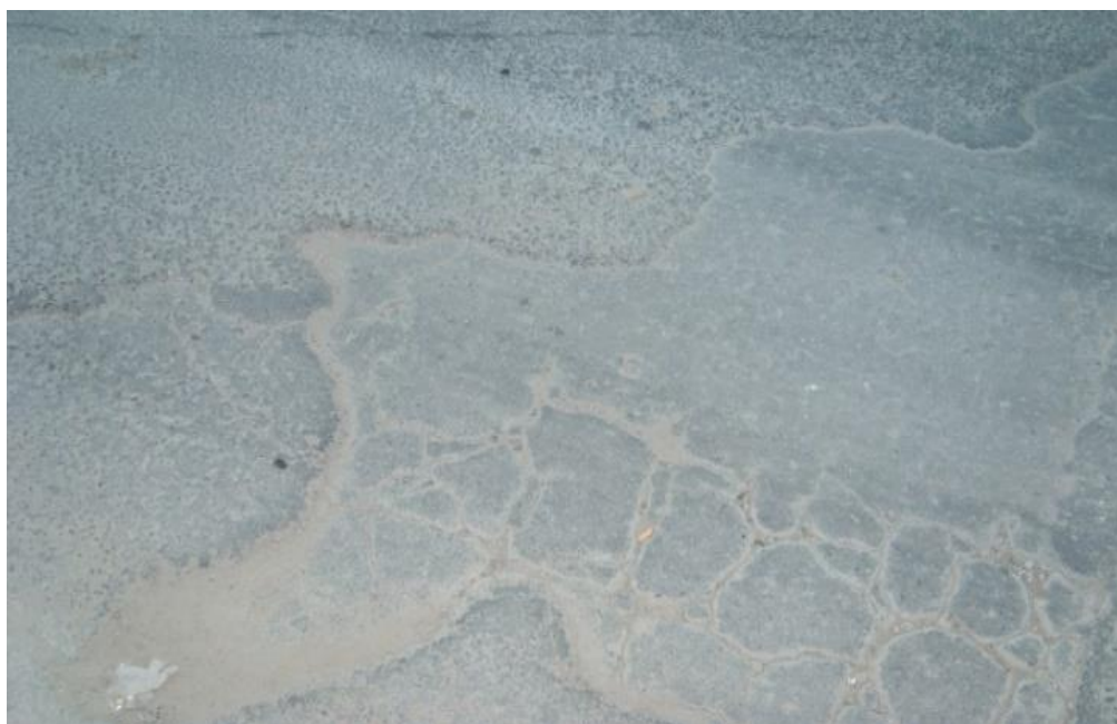
Figura 36. Parche (PCH), Fisuras en Bloque (FB) y Afloramiento de Finos (AFI). Severidad: Alta.
