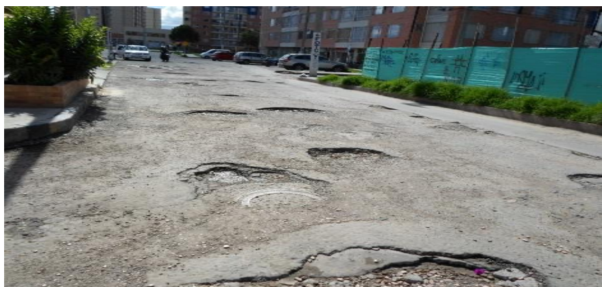
Figura 5. Malla vial local deteriorada. Baches y Deformaciones
