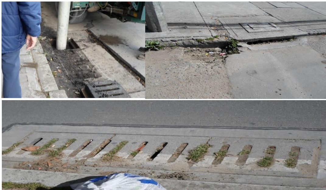
Figura 8. Estructuras de drenaje obstruidas
