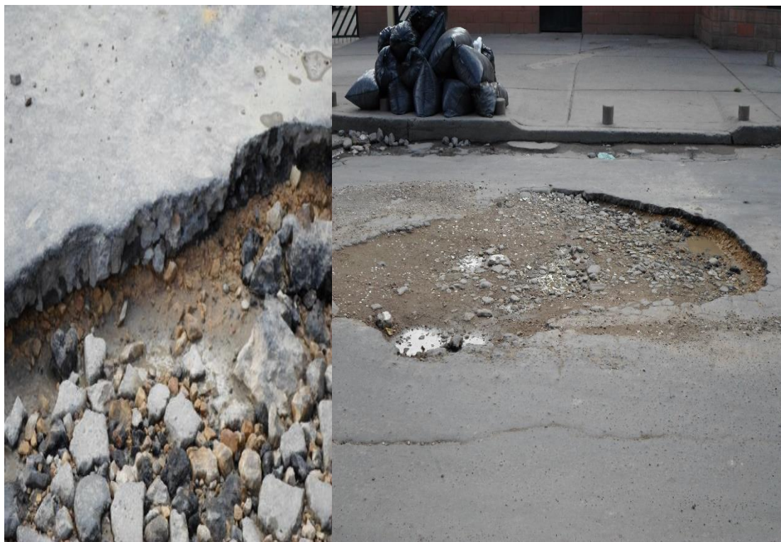
Figura 37. Bache (BCH) y Pérdida de Agregado (PA). Severidad: Alta
