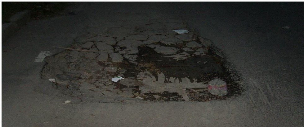
Figura 25. Descascaramiento (DC), Fisuras en Bloque (FB) y Bache (BCH). Severidad: Alta.
