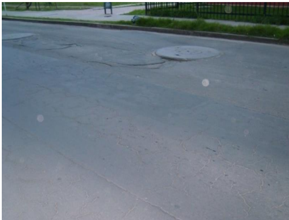
Figura 33. Hundimiento (HUN), Abultamiento (AB), Fisuras (FL, FT) y Pulimientos (PU). Severidad: Alta
