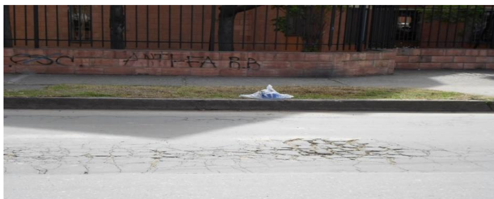
Figura 28. Piel de Cocodrilo (PC), Ahuellamiento (AHU) y Fisuras de Borde (FBD). Severidad: Alta.
