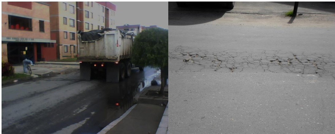
Figura 9. Tránsito de vehículos pesados de construcción. Piel de cocodrilo.
