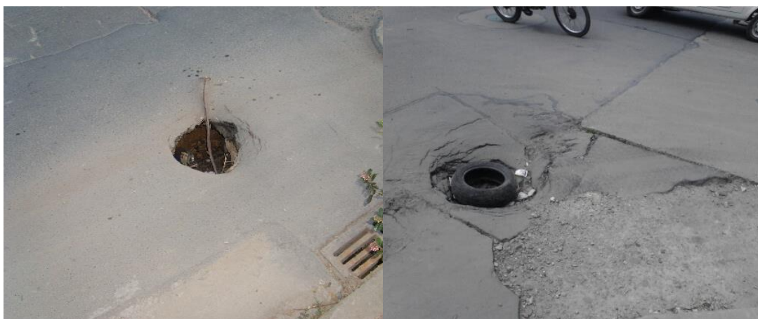
Figura 13. Valles de Refous. Hundimiento, Baches, Piel de cocodrilo y Abultamientos
