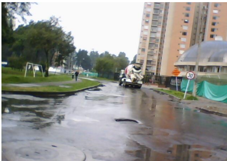
Figura 20. Descascaramiento (DC) y Hundimiento (HUN), Problemas de Drenaje. Severidad: Alta.
