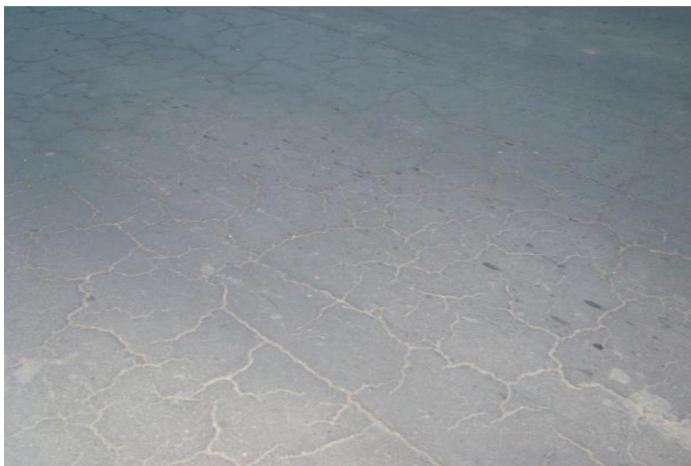
Figura 32. Piel de cocodrilo (PC) y Fisuras en Bloque (FB). Severidad: Alta.
