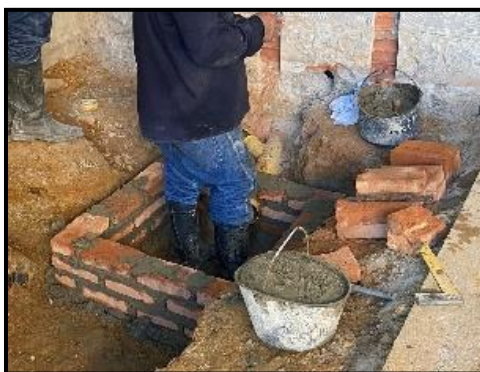
Figura 37. Caja de inspección Club Unión
