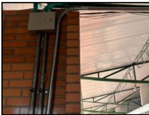
Figura 71. Instalación ducto San Francisco de Asís
