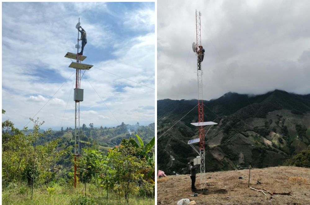
Figura 4. Instalación de estaciones repetidoras mediante radioenlace
