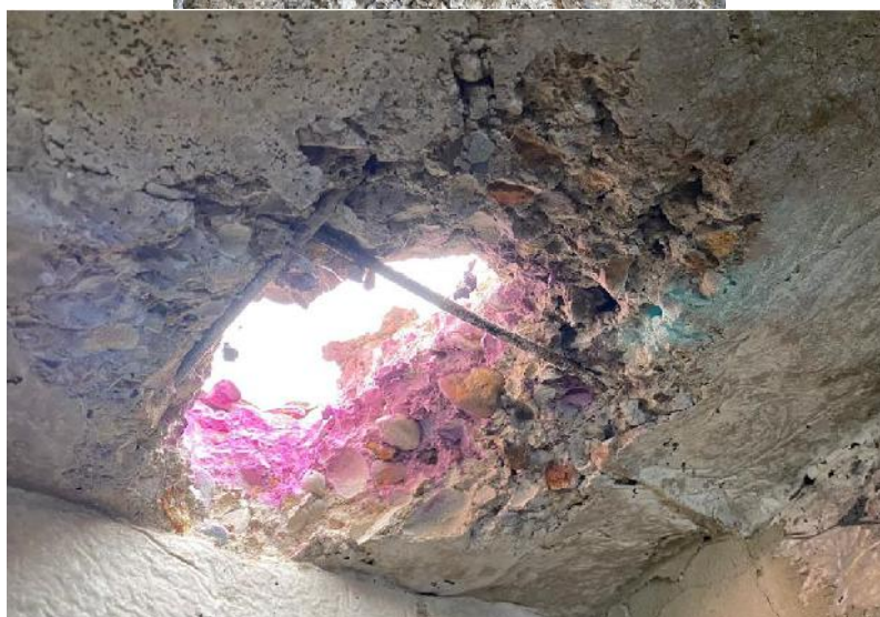
Ilustración 43 - Carbonatación N5. Se observa refuerzo de 4mm +/- 1mm de diámetro
