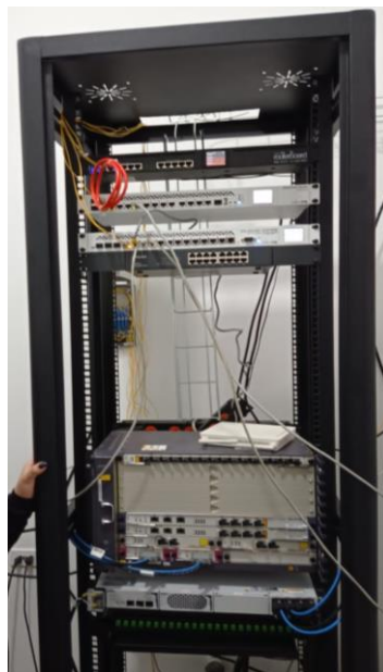
Figura 7. Armario OLT en Funcionamiento.
