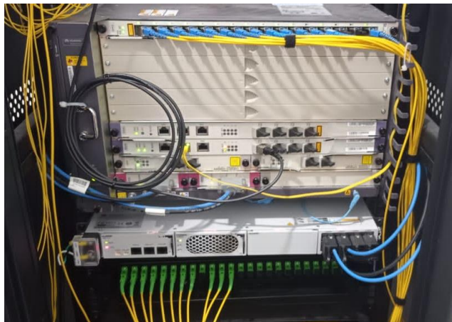
Figura 6. OLT Huawei MA5683T Instalado.
