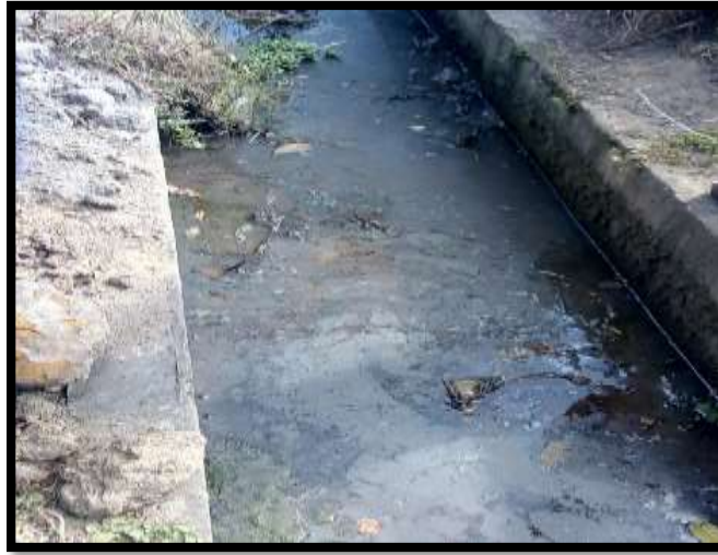
Ilustración 14 – Canaleta conductora de aguas residuales mineras
