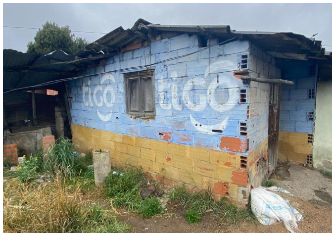
Figura 64. Grietas y uniones de la vivienda
