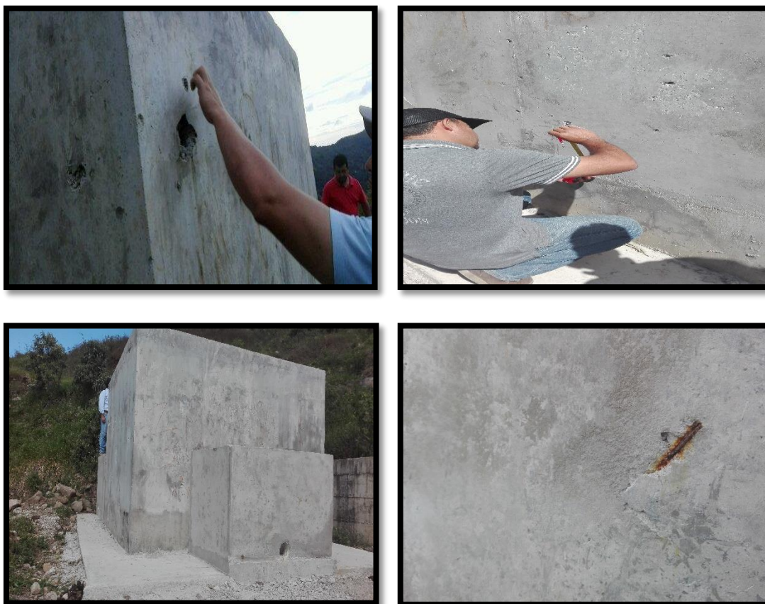
Fotografía 5,6,7,8. Tanque No. 11 tipo 1 Tipo 1 Vereda La Picacha (Volcan)
