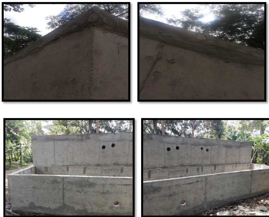
Fotografía 33,34,35,36. Tanque No. 19 Tipo 3 Vereda La Victoria (Alto Luna)
