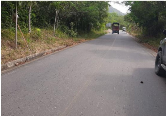
K0+350 sobre carpeta asfáltica
