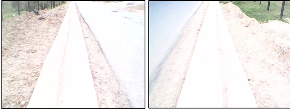
Ilustración 7. Cuneta lado Derecho sentido Montería-Cerete
