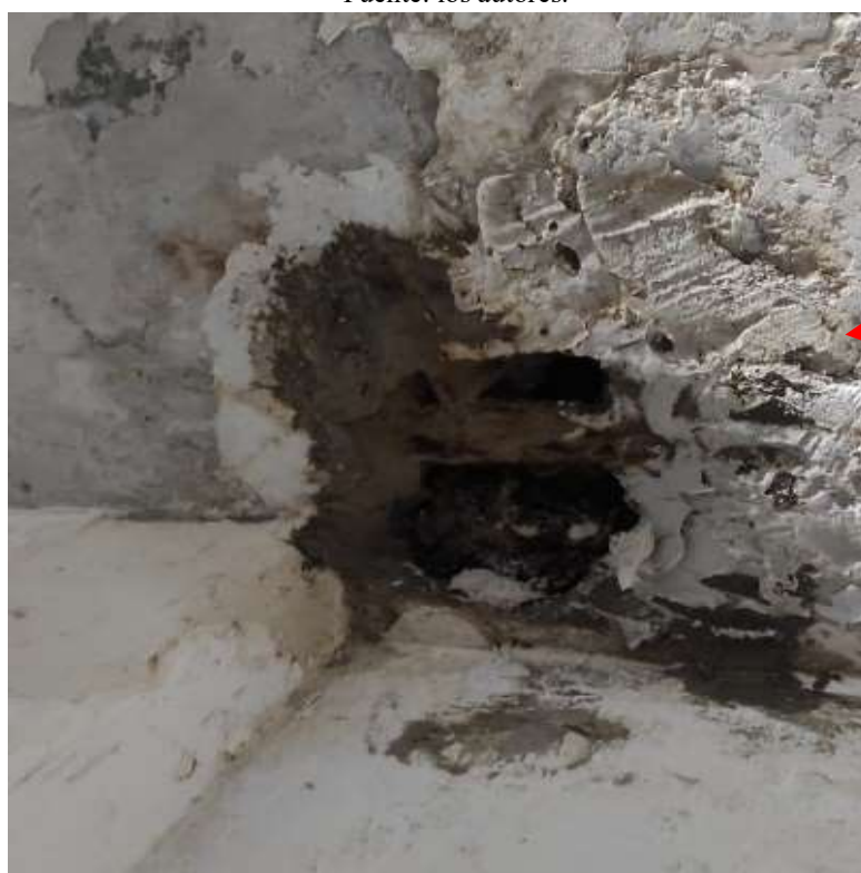
Ilustración 7. Lesión humedad en cielorraso losa de entrepiso (HC1). Fuente: los autores.
