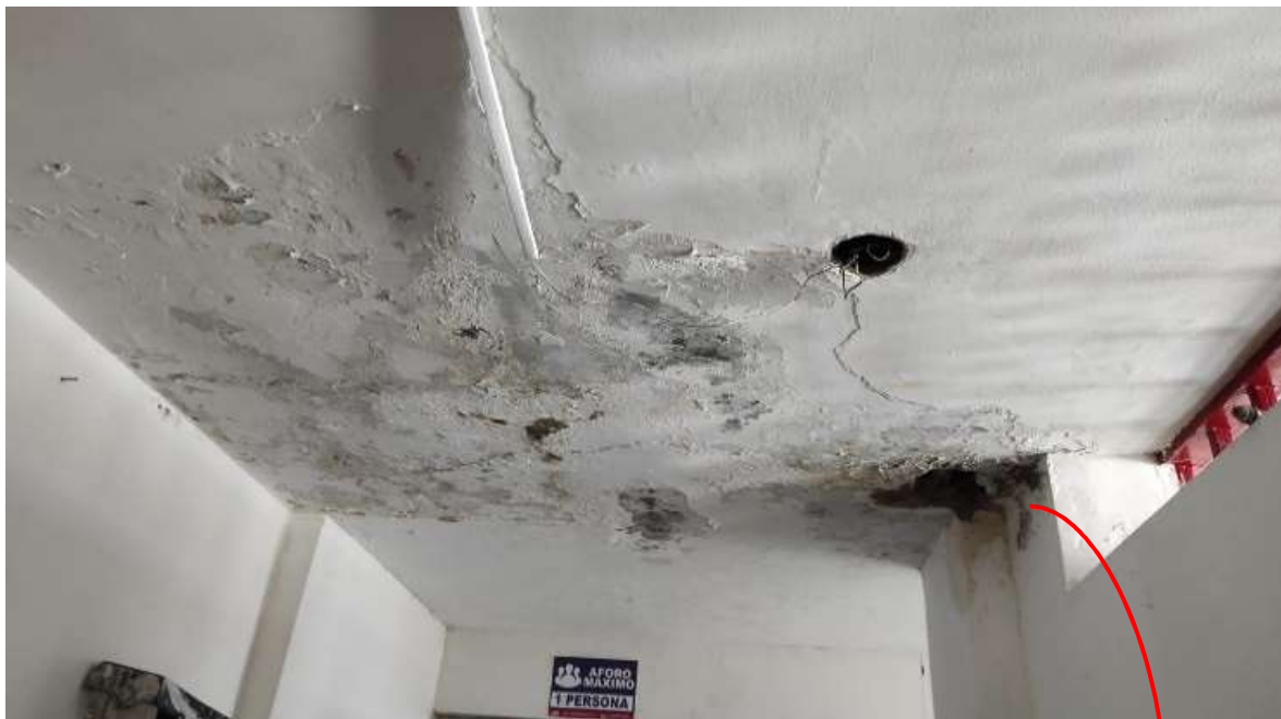
Ilustración 6. Lesión humedad en cielorraso losa de entrepiso (HC1). Fuente: los autores.
