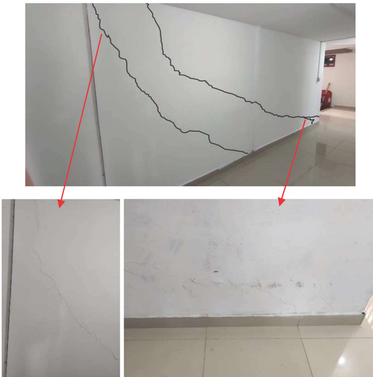
Ilustración 11. Lesión Grieta en muro de mampostería no estructural (GM1). Fuente: los autores.
