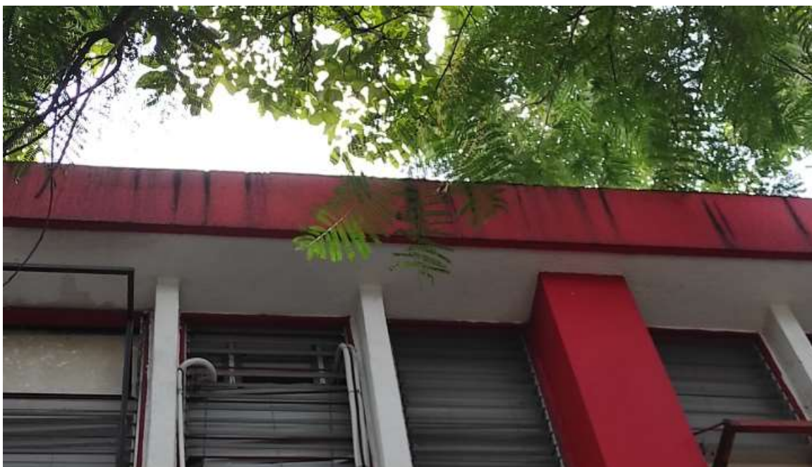
Ilustración 17. Lesión Suciedad por lavado diferencial en fachada (SL1). Fuente: los autores.
