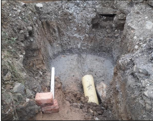
Figura 40: Pozo 1 redes instaladas Fuente: Autor
