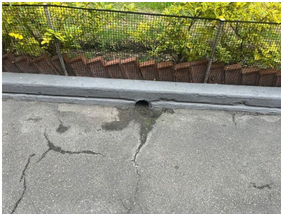
Figura 18. Desagües bajo rasante
