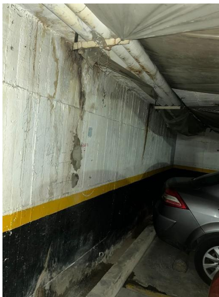
Figura 2. Muros de contención perimetrales y filtraciones de agua
