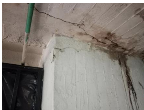
Figura 4. Fisuras y humedades placa entre piso
