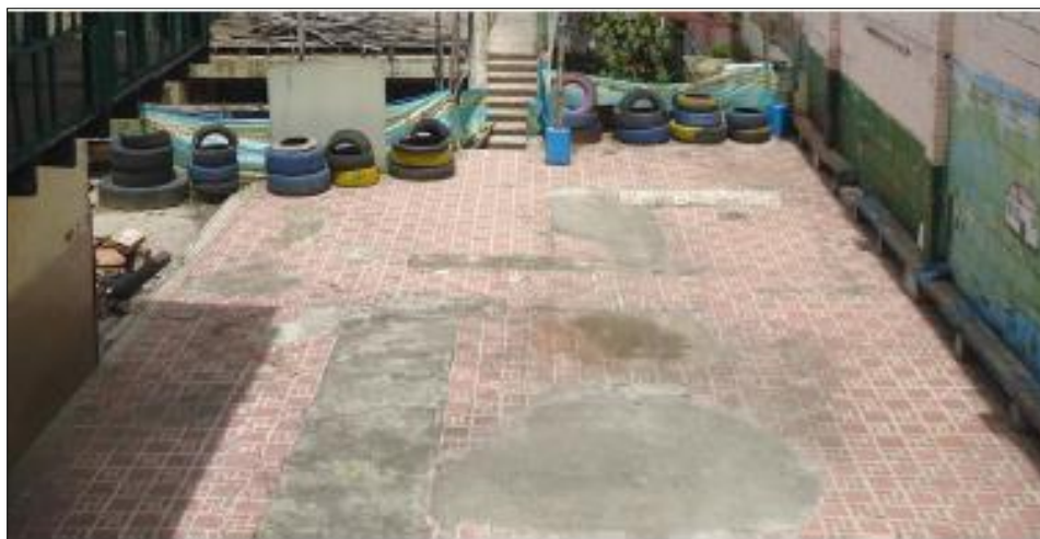
Ilustración 25. Lagunas en los pisos de la zona del patio interior Fuente: Consorcio CEYCO-BAC
