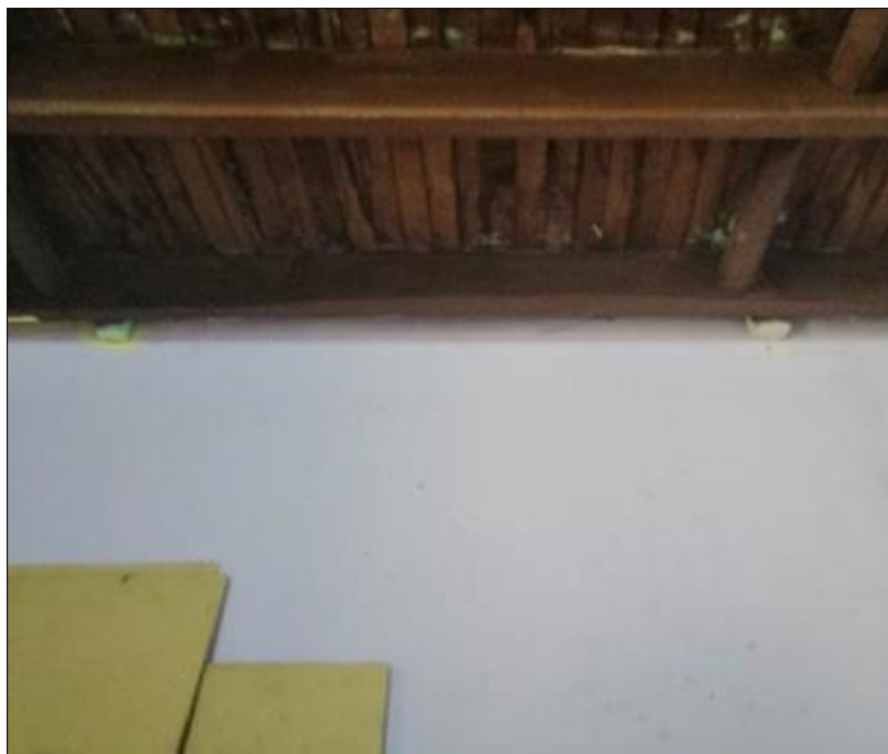
Ilustración 58. Estructura en madera en el Salón E 101 con pandeo Fuente: Consorcio CEYCO-BAC
