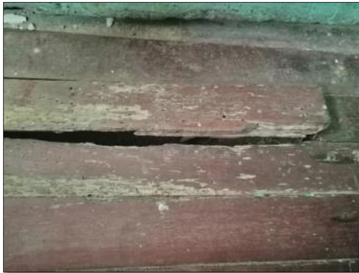
Ilustración 37. Detalle del piso en madera en el Salón 1 con lesiones Fuente: Consorcio CEYCO-BAC
