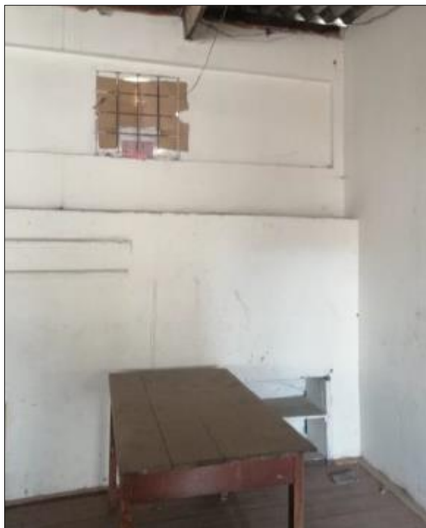
Ilustración 74. Falta de continuidad de la cornisa hacia el interior del espacio en el Salón E 201 Fuente: Consorcio CEYCO-BAC
