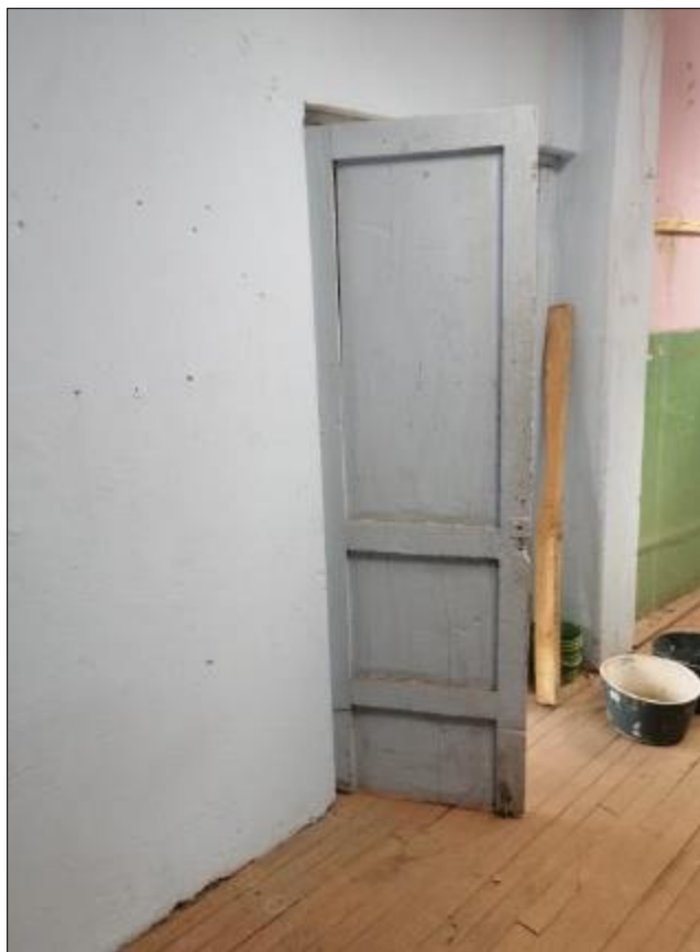
Ilustración 76. Puerta de ingreso al salón E 202 cortada en su parte inferior Fuente: Consorcio CEYCO-BAC
