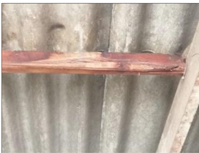
Ilustración 39. Viga en madera en la estructura de cubierta de segundo piso con evidencias de pudrición blanca Fuente: Consorcio CEYCO-BAC
