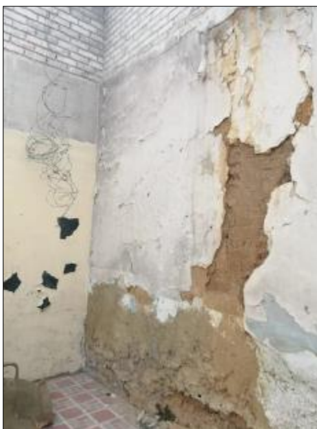
Ilustración 32. Muro sobre el eje A después del eje 4 donde el volumen fue destruido
