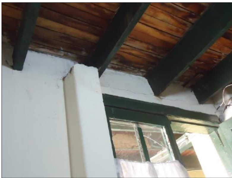
Ilustración 23. Fisuras y grietas generadas por el empuje de las vigas de entrepiso sobre la estructura muraria
