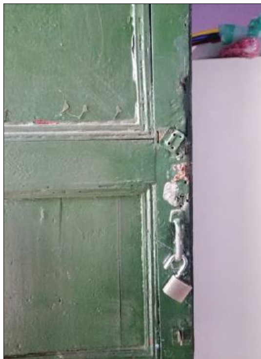
Ilustración 61. Invasión por insectos en la puerta de ingreso al Salón E 101 Fuente: Consorcio CEYCO-BAC
