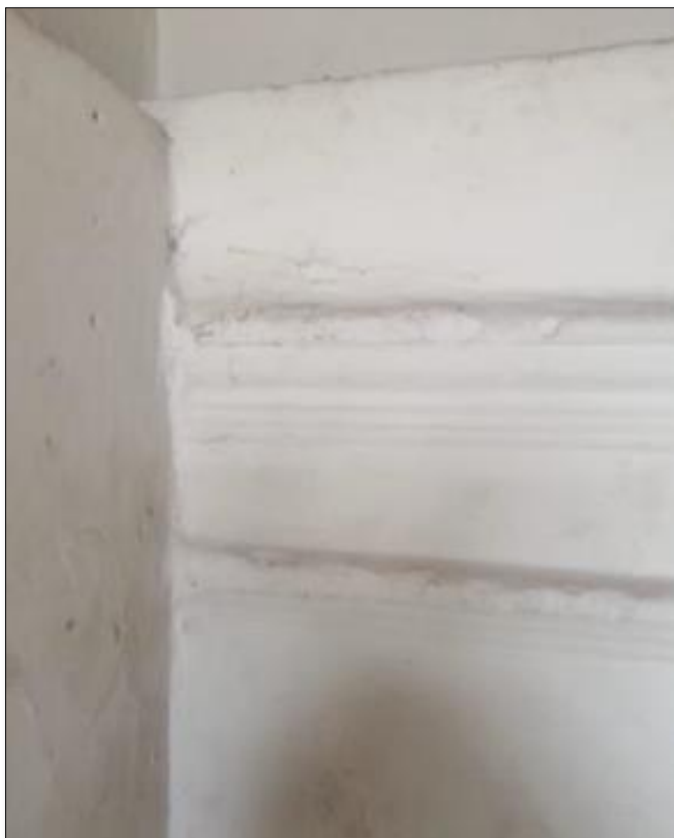
Ilustración 73. Vsta de la cornisa con fractura y pérdida de algunos fragmentos de la misma en el Salón E 201.
