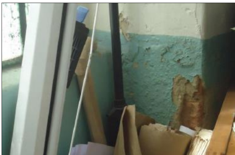
Ilustración 18. Eflorescencia al interior de la fachada Fuente: Consorcio CEYCO-BAC
