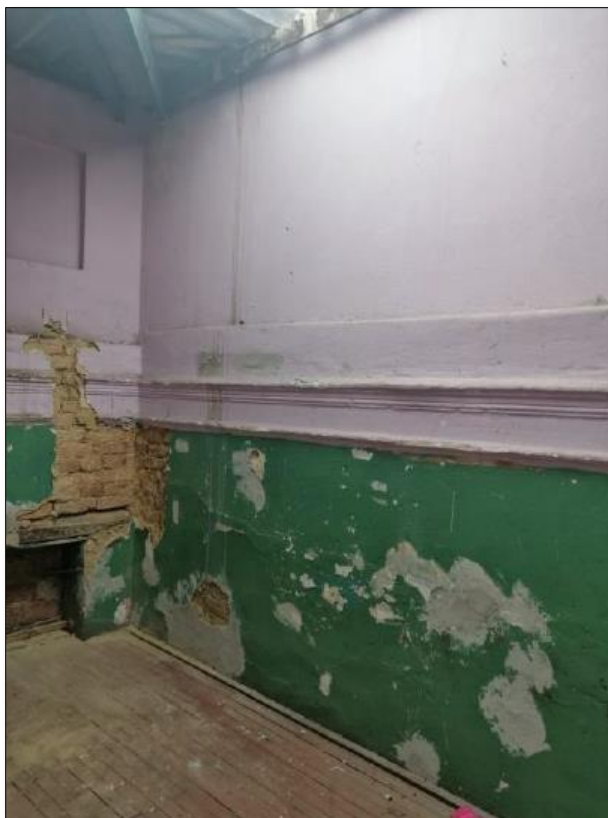
Ilustración 34. Mancha de humedad descendente en el muro sobre el eje A en el salón 6 Fuente: Consorcio CEYCO-BAC
