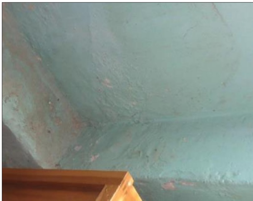
Ilustración 44. Salón E 103 con pañete de cemento en la base de algunos muros Fuente: Consorcio CEYCO-BAC
