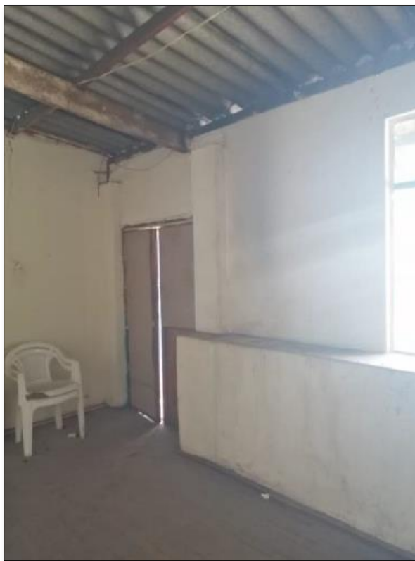
Ilustración 36. Vista hacia el ingreso del salón 5 con manchas de polución sobre los muros Fuente: Consorcio CEYCO-BAC
