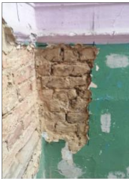
Ilustración 28. Grieta diagonal evidencia la fractura de algunos mampuestos en adobe Fuente: Consorcio CEYCO-BAC
