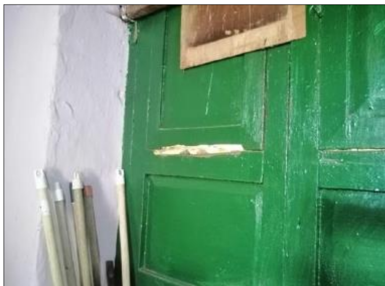
Ilustración 60. Ventana en el Salón E 101 con fracturas Fuente: Consorcio CEYCO-BAC
