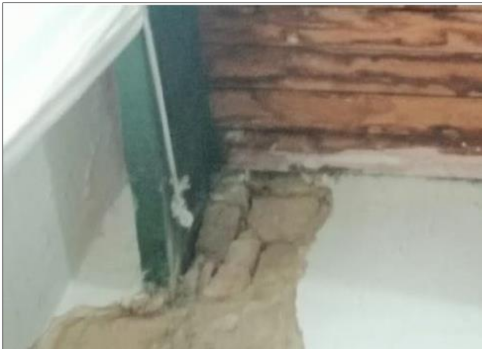
Ilustración 66. Fractura de la mampostería en adobe en el punto de apoyo de una viga de madera en el salón E 103
