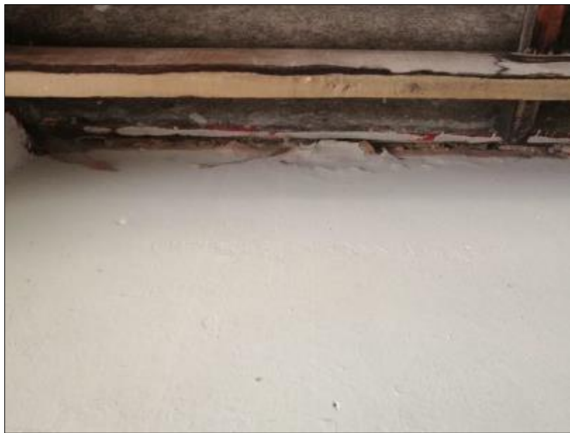
Ilustración 69. Desprendimiento de la pintura en la unión con la cubierta generada por humedad descendente en el salón E 201
