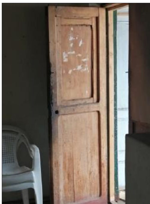
Ilustración 72. Vista de la puerta de ingreso al salón E 201 sin pintura de recubrimiento y afectación por insectos Fuente: Consorcio CEYCO-BAC
