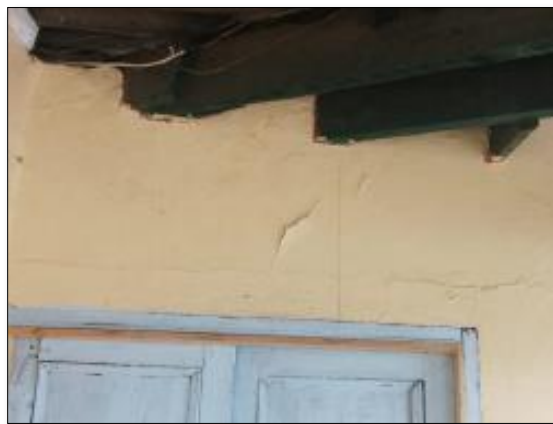
Ilustración 29. Fisuras en muro, fractura en el pañete por causas físicas sin compromiso mecánico de la estructura
