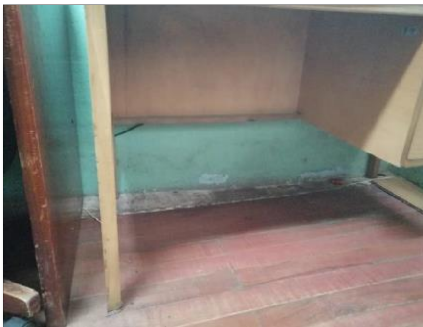
Ilustración 65. Manchas por humedad ascendente en la base del muro sobre el eje A en el Salón E 103 Fuente: Consorcio CEYCO-BAC
