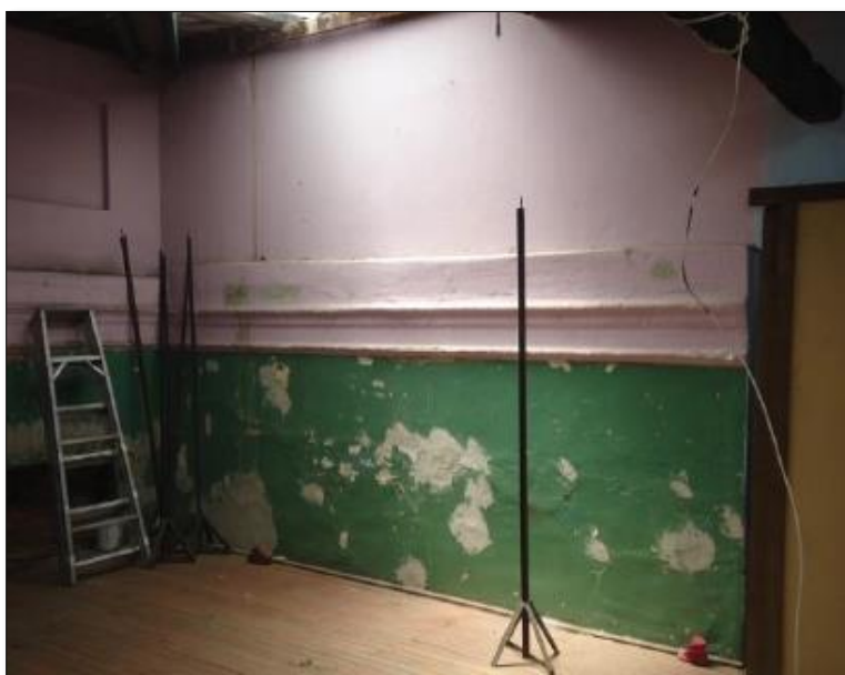
Ilustración 43. Salón E 202 con paños de pañete de cemento sobre el muro oriental Fuente: Consorcio CEYCO-BAC
