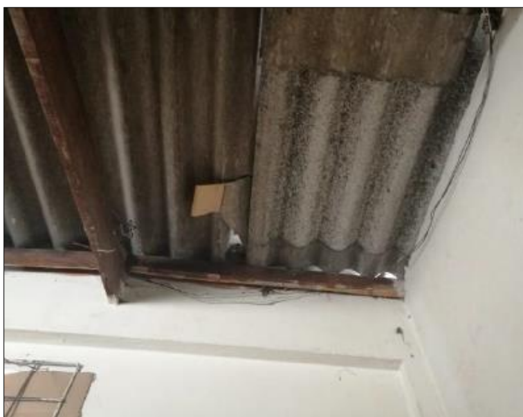
Ilustración 70. Vista del manto de cubierta del salón E 201 donde se evidencian varias fracturas y cambios de material
