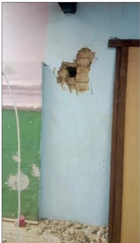
Ilustración 77. Grieta del muro posterior al de conservación del salón E 202 Fuente: Consorcio CEYCO-BAC
