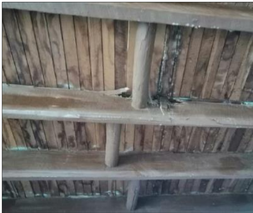
Ilustración 57. Estructura en madera en el Salón E 101 con fractura por pudrición blanca Fuente: Consorcio CEYCO-BAC
