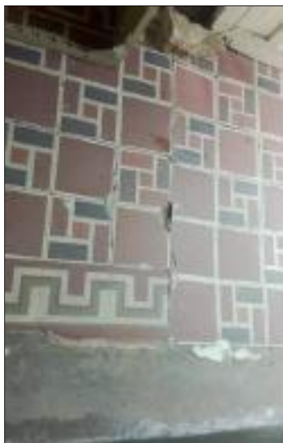
Ilustración 24. Fracturas en las baldosas de cemento
