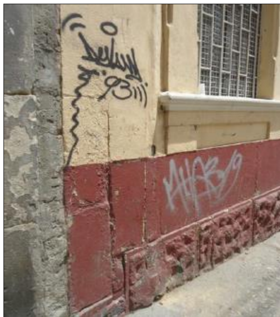
Ilustración 41. Graffiti sobre la fachada con pintura en aerosol Fuente: Consorcio CEYCO-BAC
