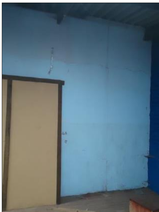
Ilustración 22. Grietas en el muro oriental en tierra entre los ejes 3 y 4 Fuente: Consorcio CEYCO-BAC
