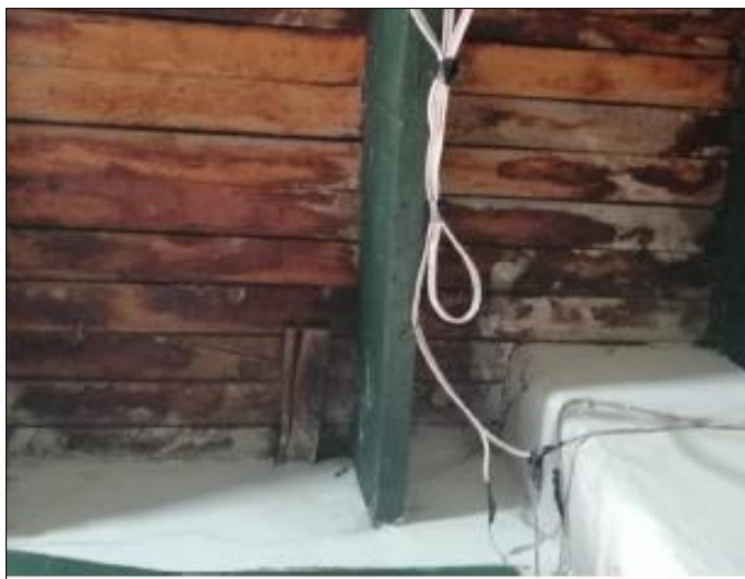
Ilustración 38. Manchas de hongos en la madera del salón 2 Fuente: Consorcio CEYCO-BAC
