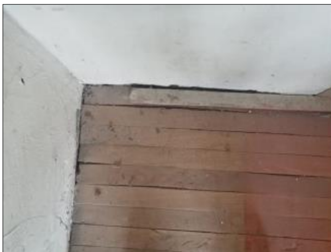
Ilustración 71. Vista del piso en madera del salón E 201 con fracturas y deformaciones Fuente: Consorcio CEYCO-BAC
