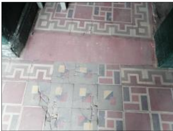
Ilustración 30. Fractura de baldosas de piso de cemento Fuente: Consorcio CEYCO-BAC
