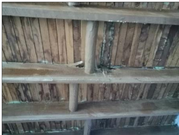
Ilustración 40. Fractura de elemento en madera en el salón 2 como consecuencia del debilitamiento por pudrición blanca Fuente: Consorcio CEYCO-BAC
