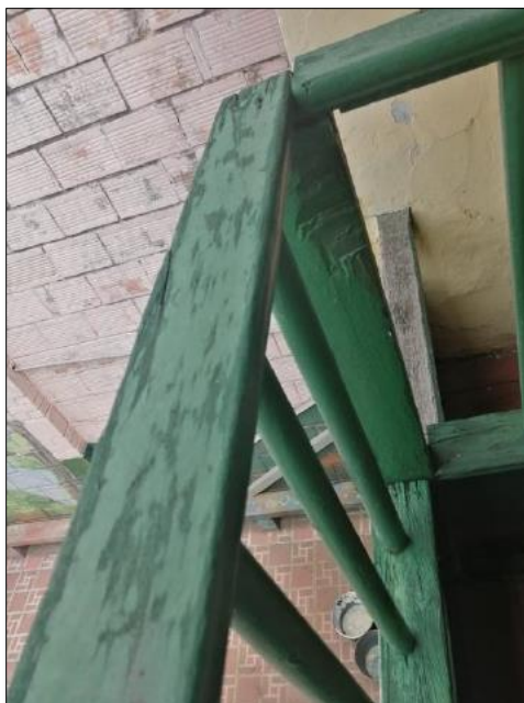
Ilustración 35. Baranda en corredor del segundo piso frente al salón 5 con degradación por la luz Fuente: Consorcio CEYCO-BAC
