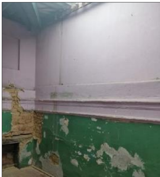
Ilustración 78. Mancha por humedad descendente sobre el muro oriental en el salón E 202
