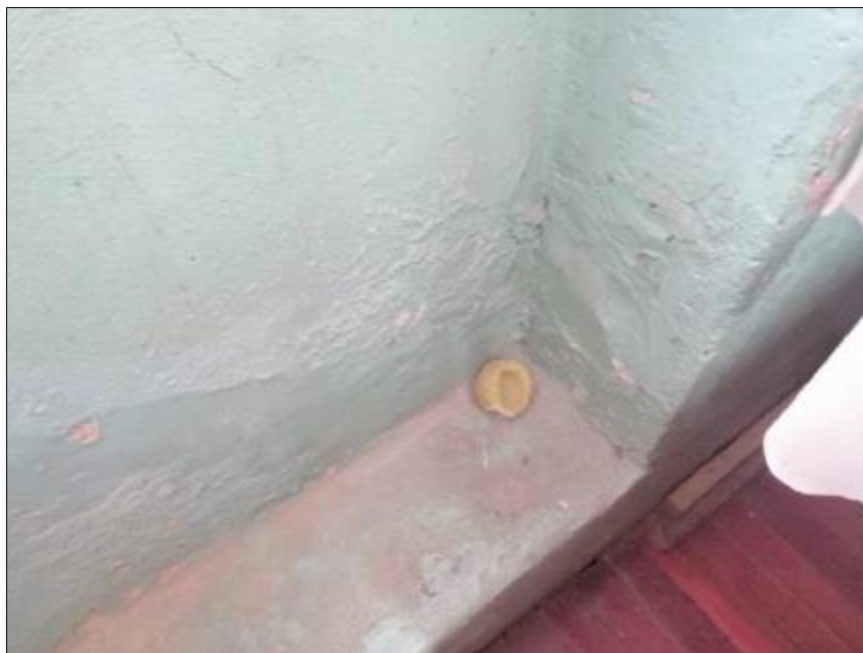
Ilustración 64. Eflorescencias en la base del muro de fachada en el salón E 103 Fuente: Consorcio CEYCO-BAC
