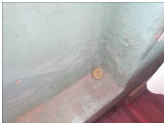
Ilustración 31. Eflorescencia en el salón 2 en la base de los muros de la fachada principal hacia el interior del espacio
