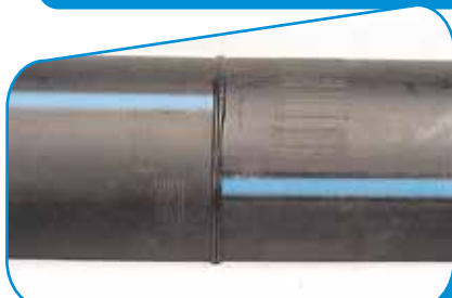
FUNDIDO A BAJA PRESIÓN REBORDE INCOMPLETO
