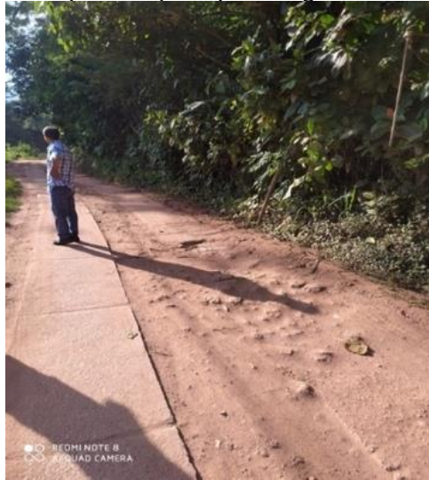
Figura 20. Placas de concreto simple con fallo por carga ultima
