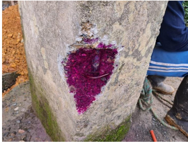
Ilustración 35 Losa con 6 Cm de frente de Carbonatación
