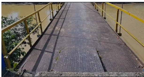
Ilustración 8 Deterioro en pasarela.
