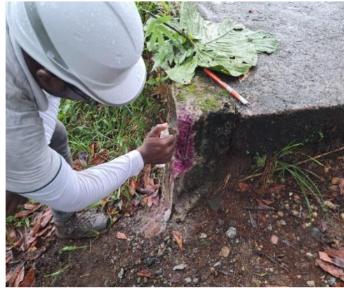
Ilustración 37 Aplicación de Fenolftaleína
