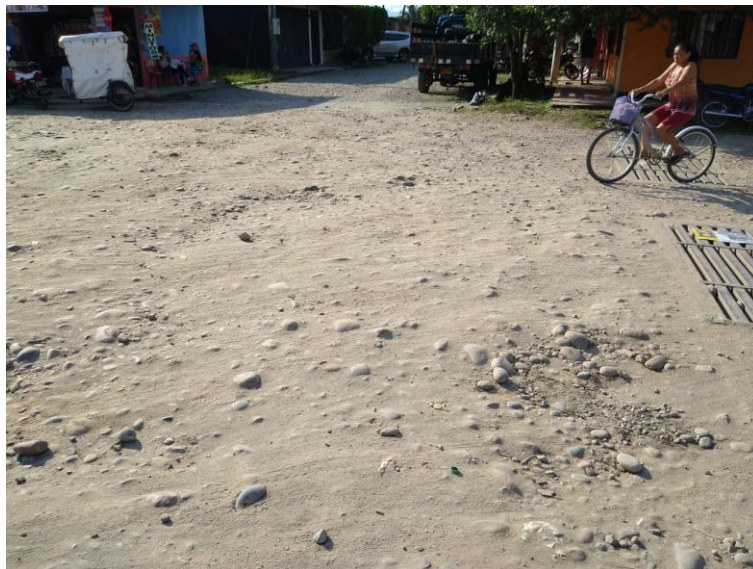
Ilustración 7-2 Ausencia de estructura de pavimento, Intersección Cra 16 - Calle 8 Fuente: Elaboración propia, 2019
