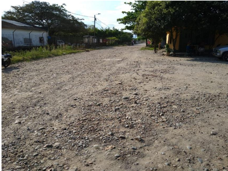
Ilustración 7-3 Ausencia de estructura de pavimento, Intersección Cra 16-Calle 10 Fuente: Elaboración propia, 2019
