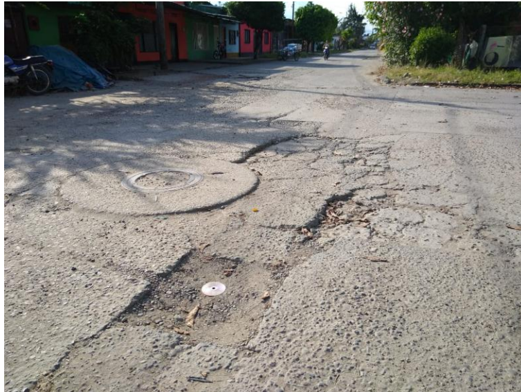
Ilustración 7-11 Grietas en sumideros (GA) Fuente: Elaboración propia, 2019
