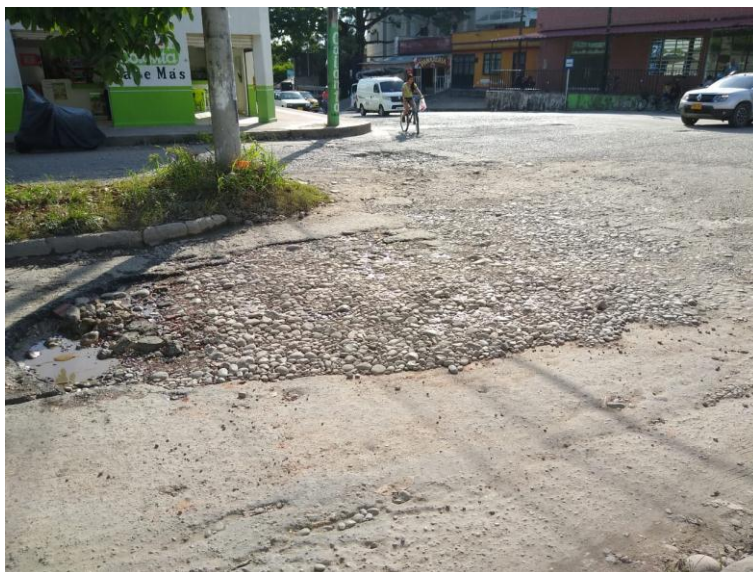
Ilustración 7-14 Bache (BCH) a la altura de la calle 15 Fuente: Elaboración propia, 2019
