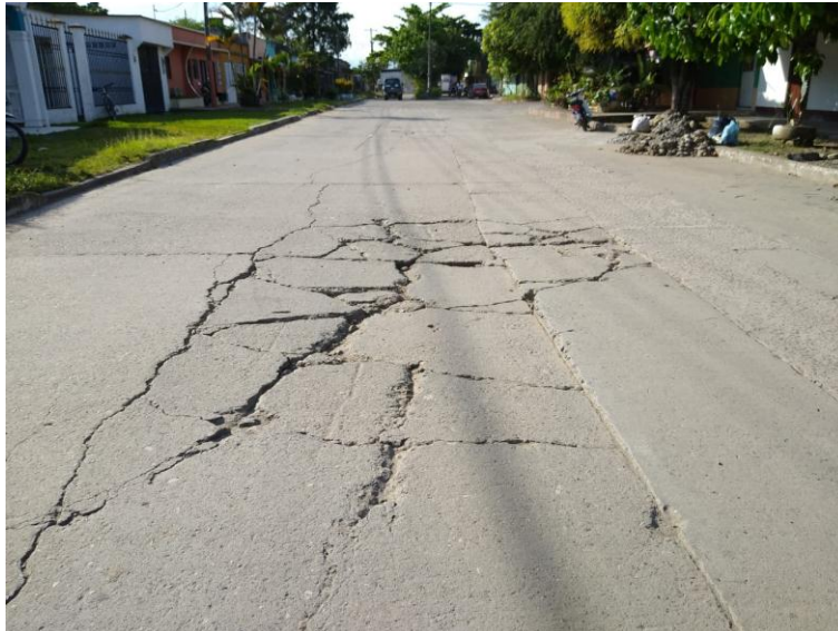
Ilustración 7-7 Grietas en Bloque (GB) y Hundimientos (HU) Fuente: Elaboración propia, 2019
