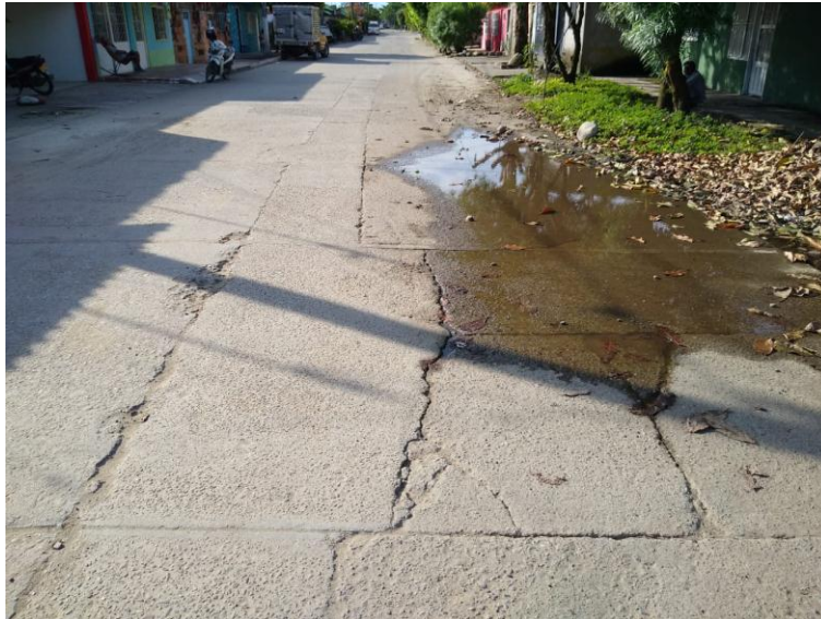
Ilustración 7-9 Grietas Longitudinales (GL) Fuente: Elaboración propia, 2019
