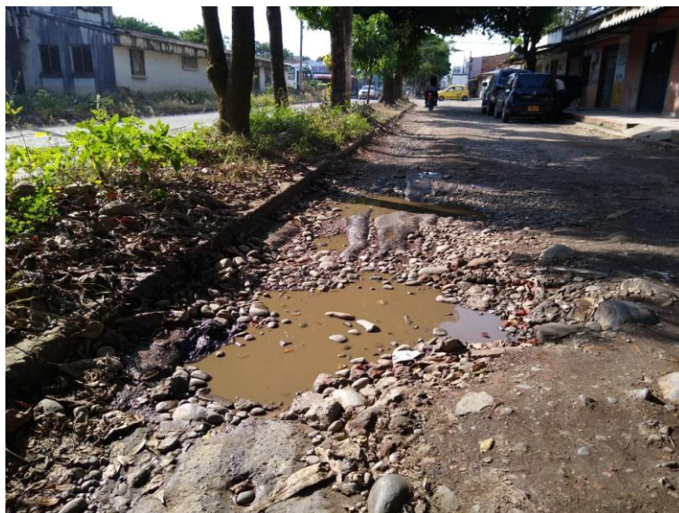
Ilustración 7-12 Bache (BCH) a la altura del Hospital antiguo Fuente: Elaboración propia, 2019
