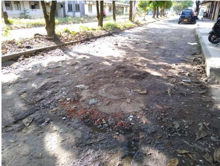
Ilustración 7-13 Bache (BCH) a la altura del Hospital antiguo Fuente: Elaboración propia, 2019
