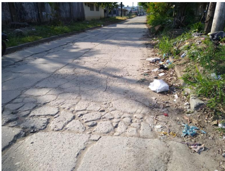
Ilustración 7-8 Grietas en Bloque (GB) Fuente: Elaboración propia, 2019
