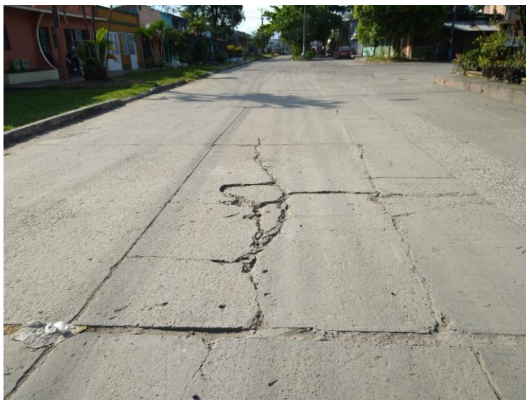
Ilustración 7-10 Grietas Longitudinales (GL) Fuente: Elaboración propia, 2019
