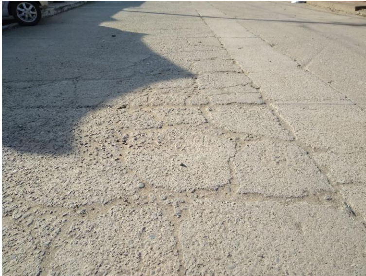
Ilustración 7-5 Grietas en bloque (GB) y Parches (PCHC) Por instalación de servicios públicos domiciliarios
