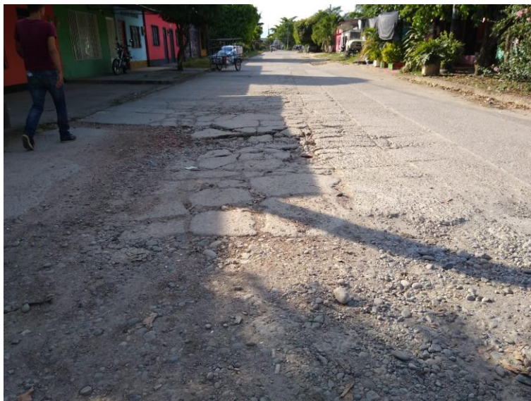
Ilustración 7-6 Grietas en Bloque (GB) y Hundimientos (HU)
