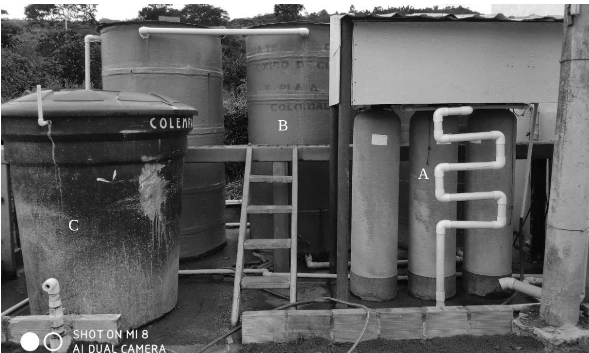
Figura 18. Vista general de la PTAP del Hotel Alejandría Resort. Filtración multipunto (A) Sistema de sedimentación de flujo ascendente (B) Tanque de preparación de solución desinfectante (C)
