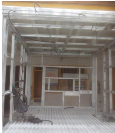
Figura 3 Cableado eléctrico de la estructura de la carrocería
