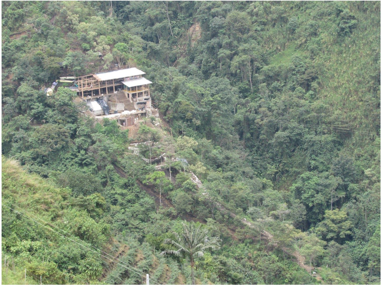
Figura B.5: Construcción de auto-denominado “Eco-Hotel” ilegal en bosque primario al lado de la Quebrada La Plata, Pastales.
