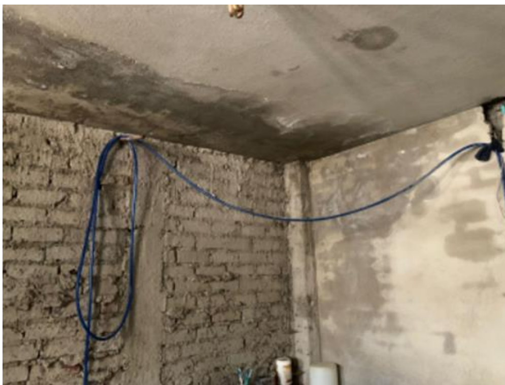
Figura 33. Humedad de vivienda.
