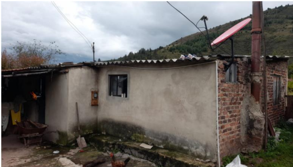
Figura 37. Vivienda con alto riesgo.
