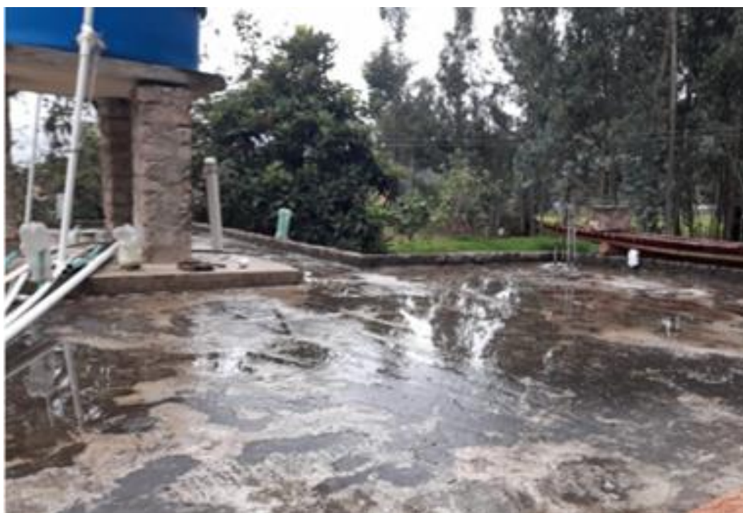
Figura 31. Agua lluvia acumulada en vivienda.
