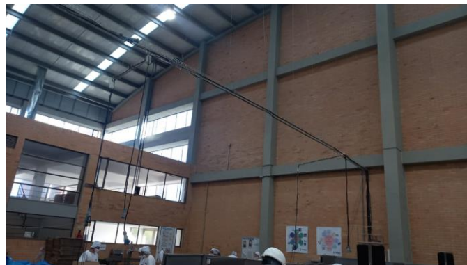
Figura 37. Red eléctrica aérea maquilas
